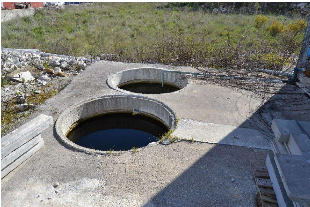
Foto 6) BENI 1 E 2 – Vasche in calcestruzzo
