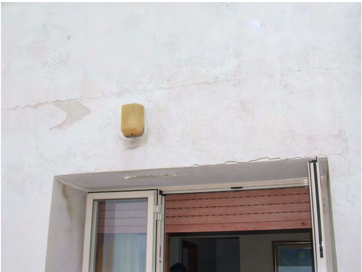
Superfici prospettiche degradate
