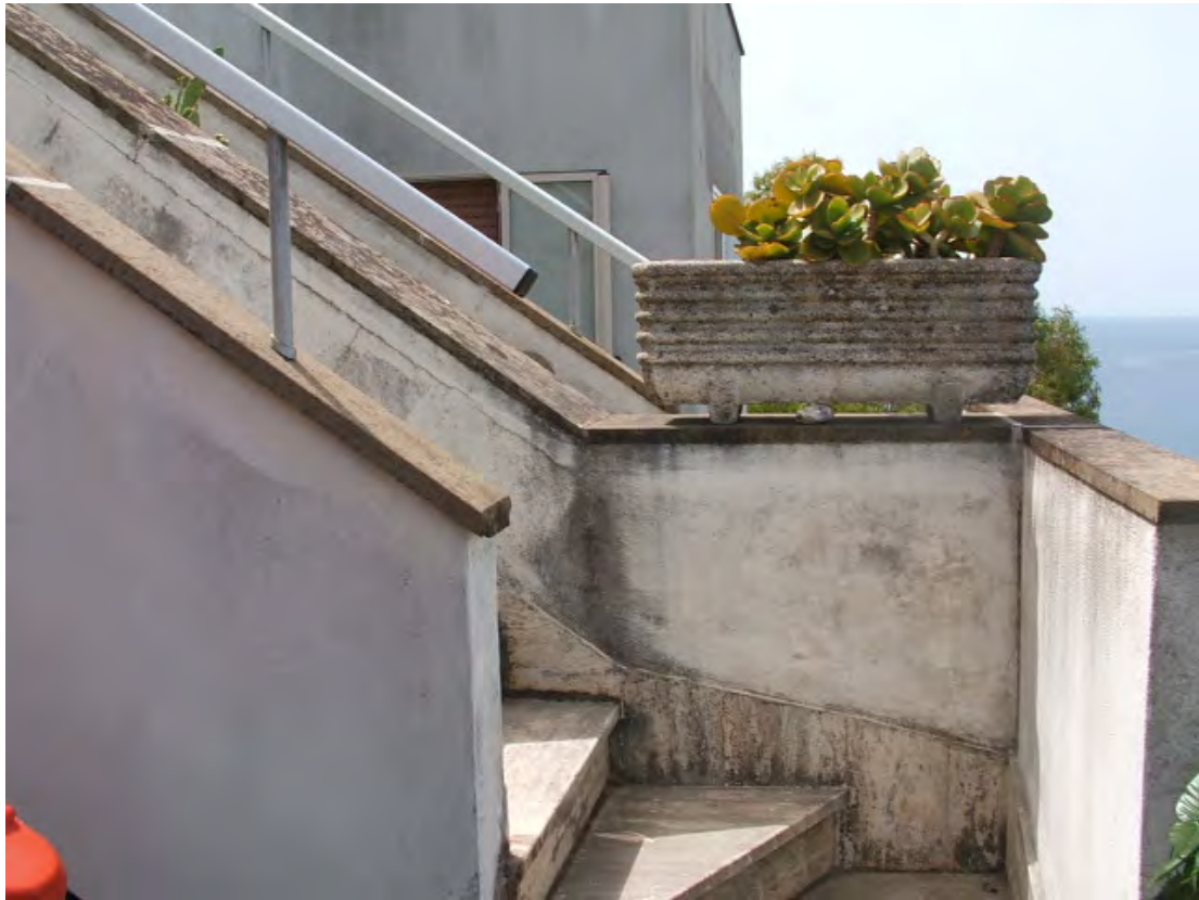
Superfici delle scale e dei parapetti con presenza di muffe e distacchi
