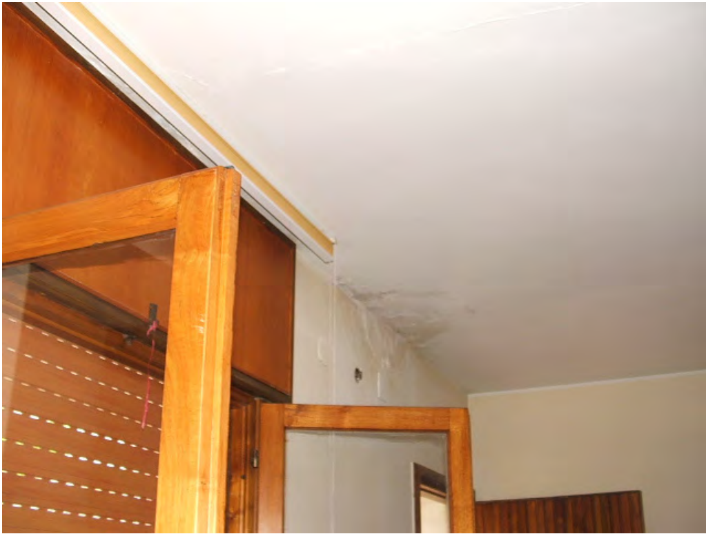
Infiltrazione acqua piovana dalla copertura
