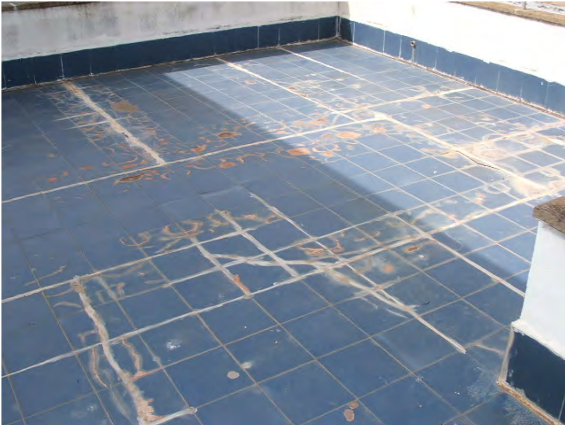
Pavimentazioni terrazzi con fenomeni di degradato
