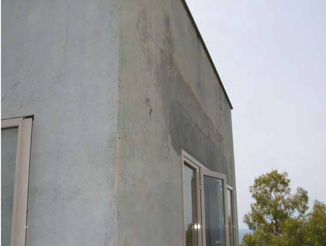
Superfici prospettiche degradate
