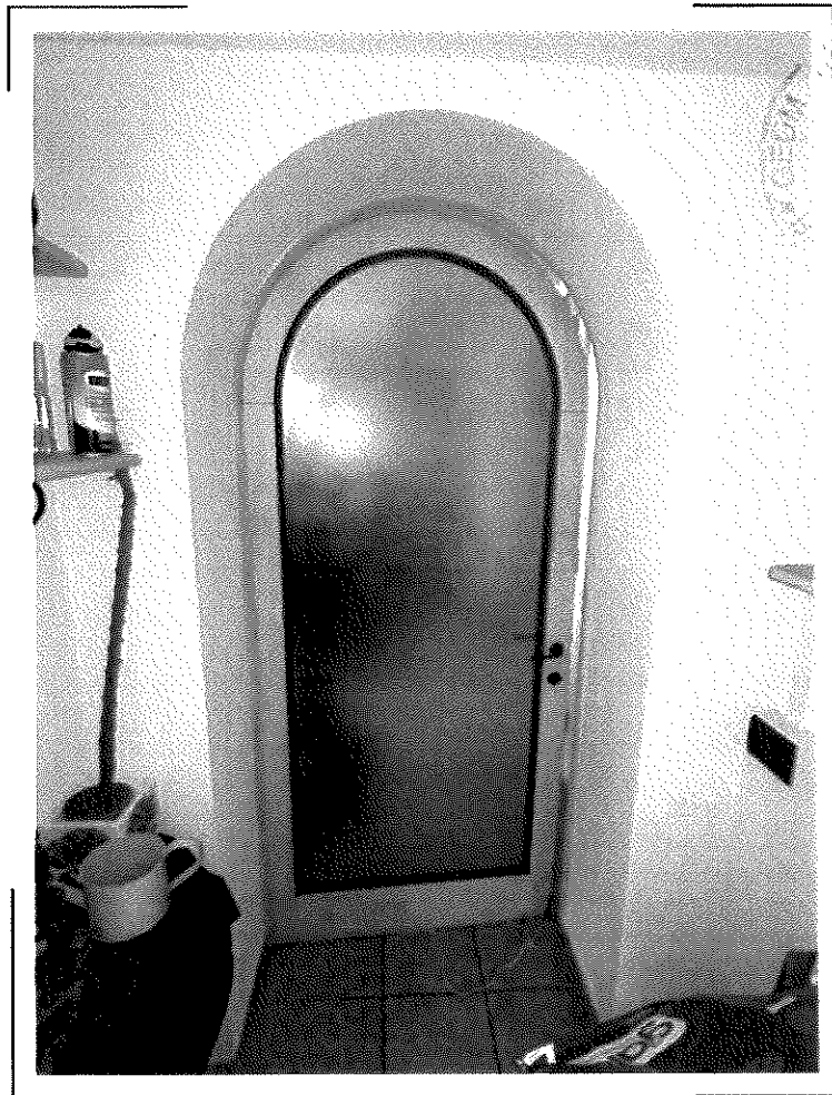
44) CF Fg. 4 p.lla 160 sub.4 – Particolare della porta pedonale che collega internamente il garage oggetto di stima al fondo e cantina al piano seminterrato facenti parte dell'unità immobiliare censita al Fg. 4 p.lla 160 sub.2 [REDACTED],
