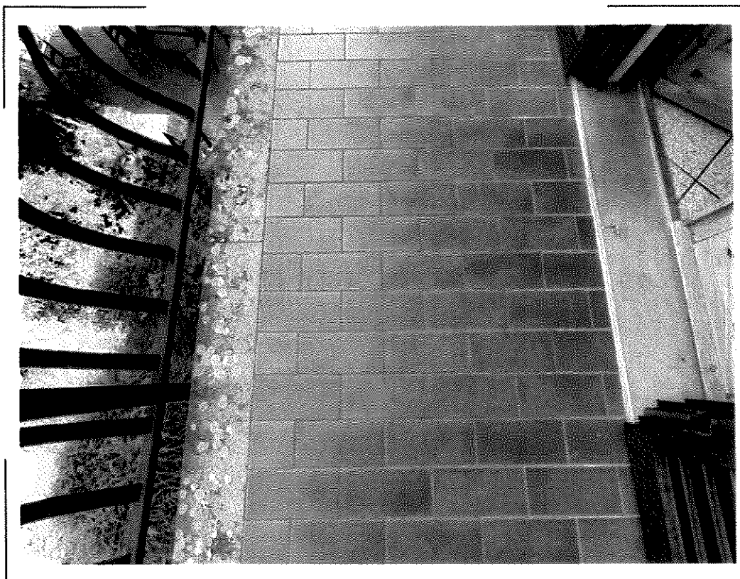
38) CF Fg. 4 p.lla 160 sub. 2 – Particolare della pavimentazione dei terrazzi ad uso esclusivo della porzione di abitazione oggetto di stima (C. 1/11/11)
