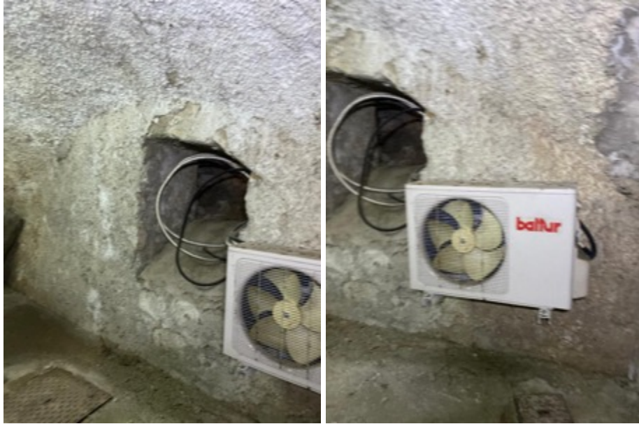
Foto da 39 a 40 : Vista motore area condizionata
