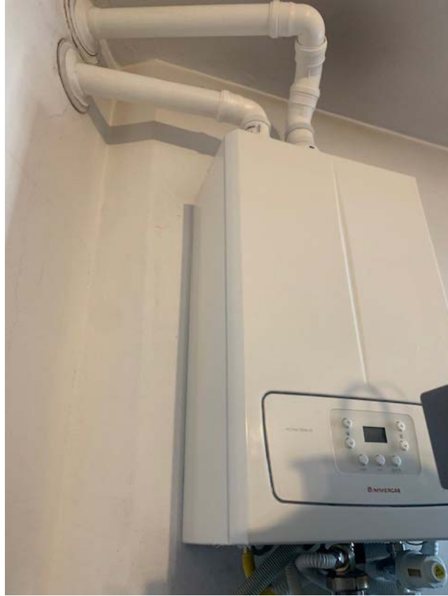
FOTO INTERNA – DETTAGLIO CALDAIA
