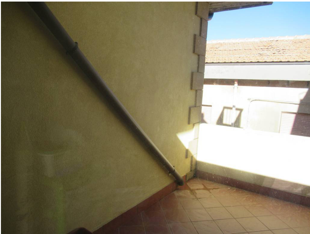
Foto n ° 28 – Parte del terrazzo senza copertura. –
