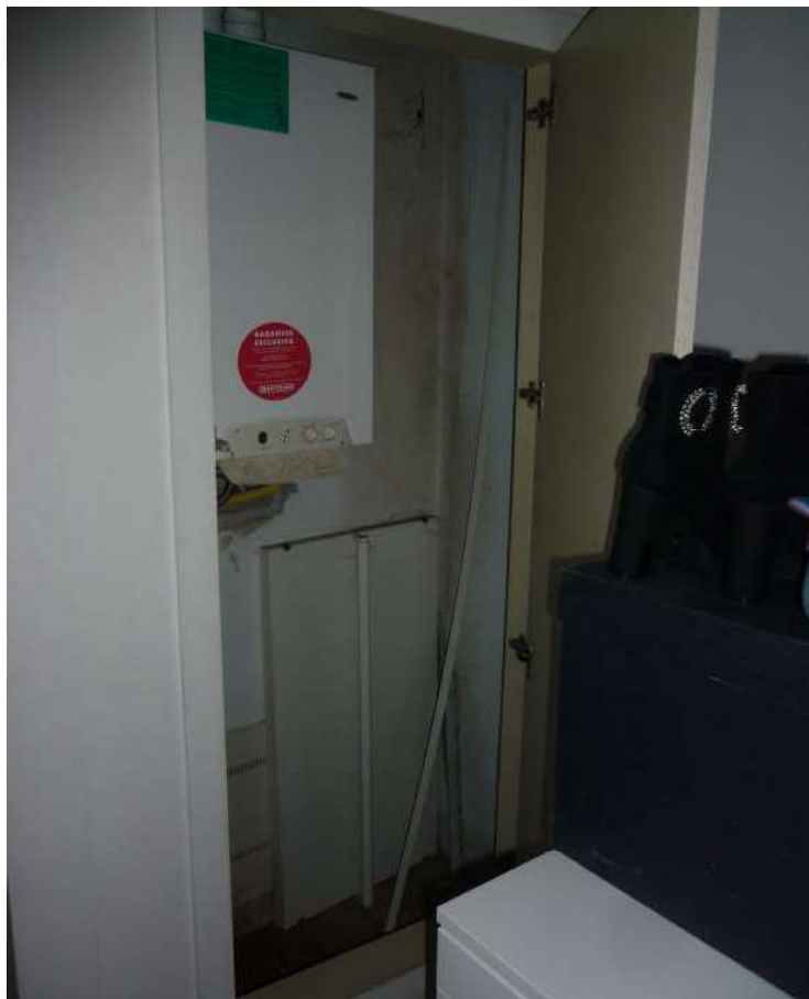
FOTO n.15 – il vano caldaia all'interno della camera
