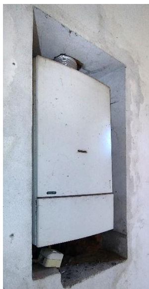
Caldaia, vano scala
