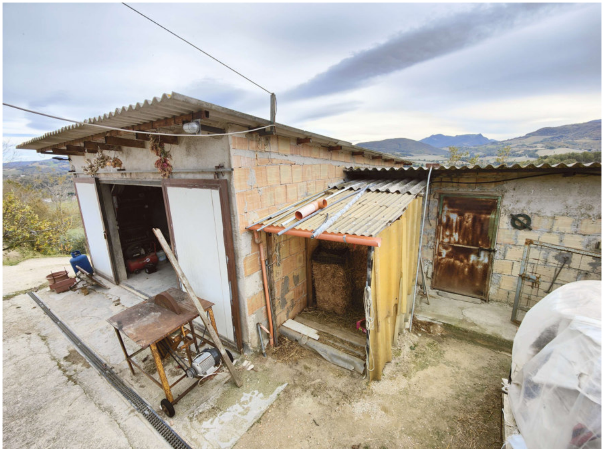
08) Struttura precaria (1) da rimuovere
