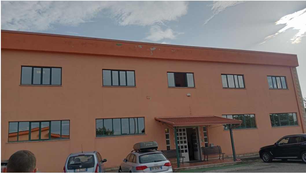
Foto 12. Prospetto frontale corpo A in cui sono evidenti cedimenti dell'intonaco sul sottotetto.
