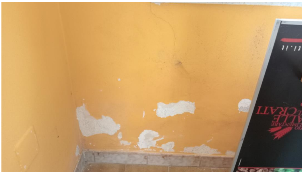
Foto 3-4. Particolari dell'infiltrazioni d'acqua sulle mura dell'immobile Corpo A.
