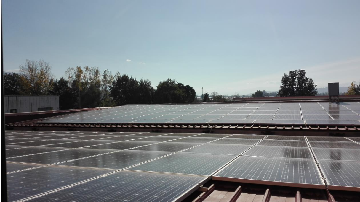
Foto 48. Particolare dei pannelli dell'impianto fotovoltaico posto sulla copertura.
