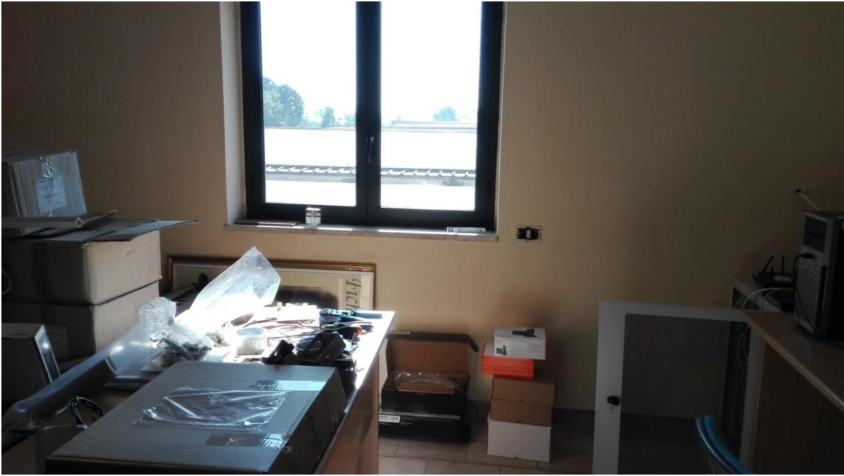
Foto 47. P articolare di una stanza ad uso server.
