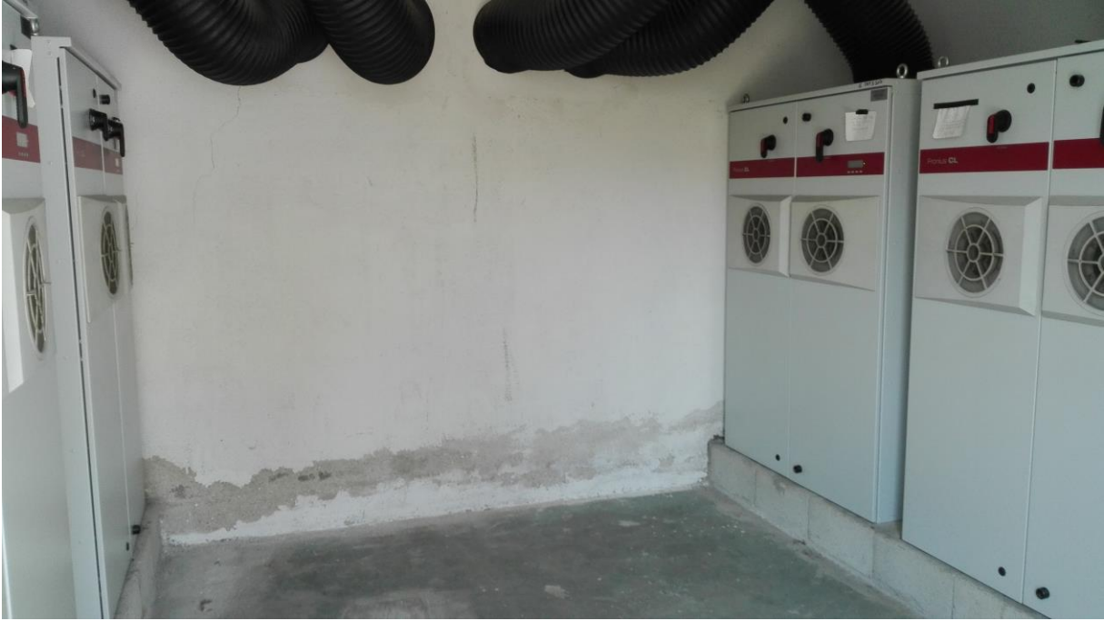
Foto 85. Locale deposito, utilizzato per l'impianto fotovoltaico.
