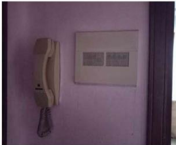
Foto n. 31-32: dettaglio del quadro elettrico e del citofono.
