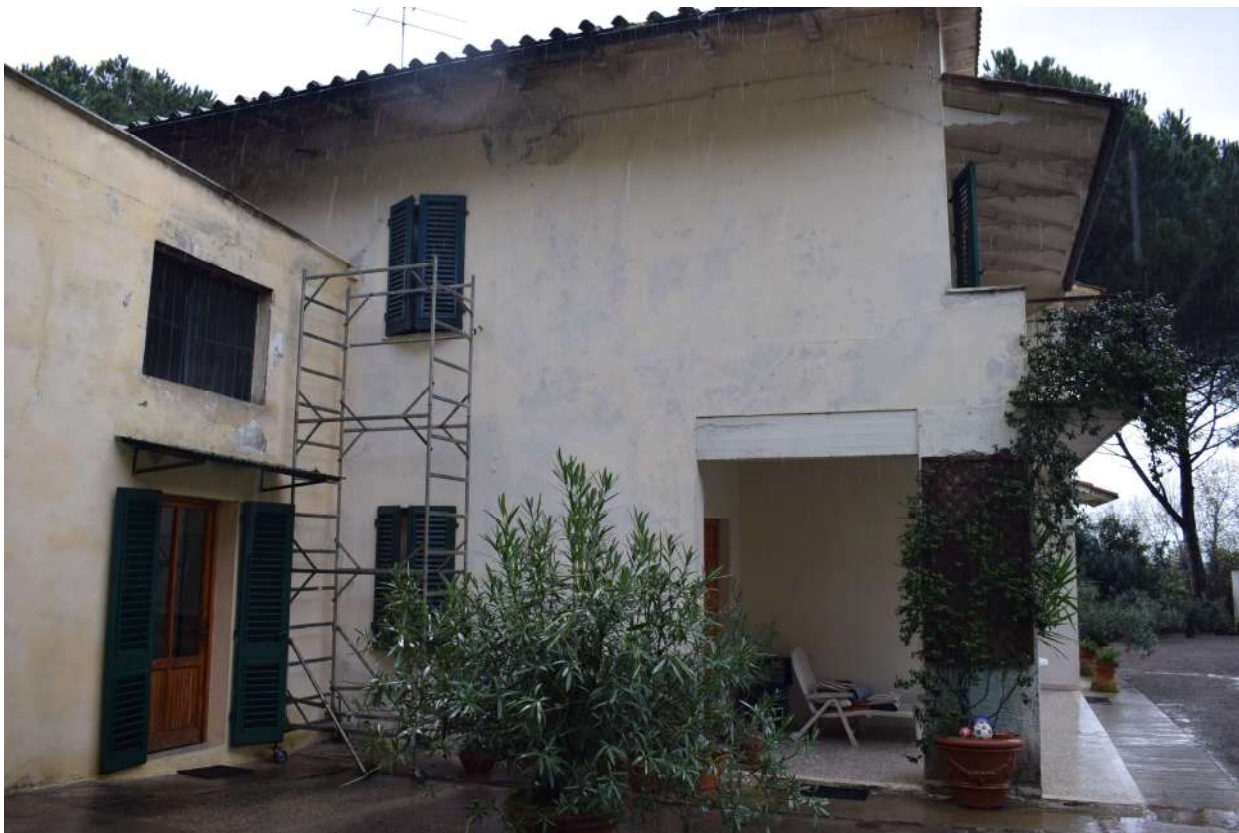
Foto n. 8_ Sopralluogo del 09/12/2019 La casa di abitazione (sub 2) con addossata la cantina/tinaia (sub 1)
