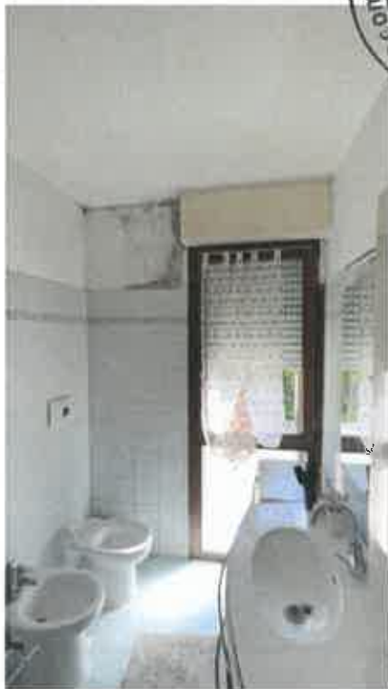
Foto n. 06 Interno abitazione (Bagno)
