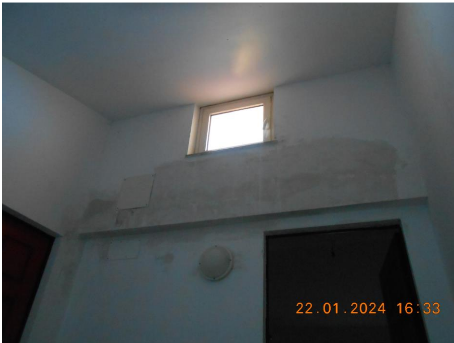
Foto n. 24 – Lotto n. 2 - Macchie di umidità
