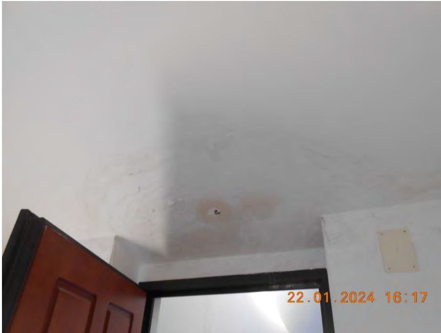
Foto n. 23 – Lotto n. 2 - Macchie di umidità
