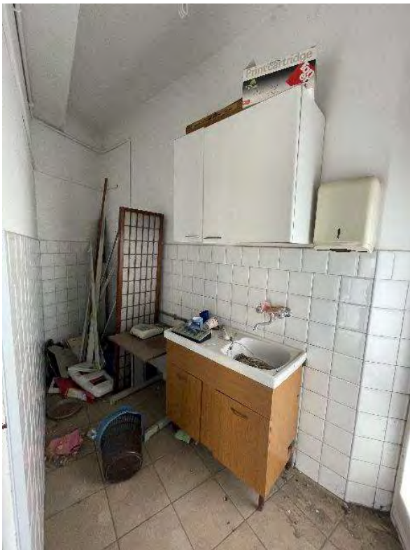
23. Locale di servizio.
