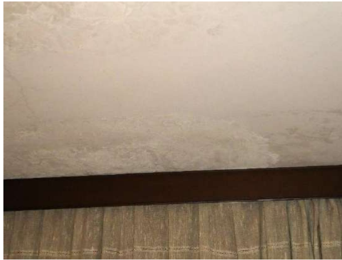
25. – Abitazione mappale 195 sub. 5: infiltrazioni presenti nei soffitti dei locali
