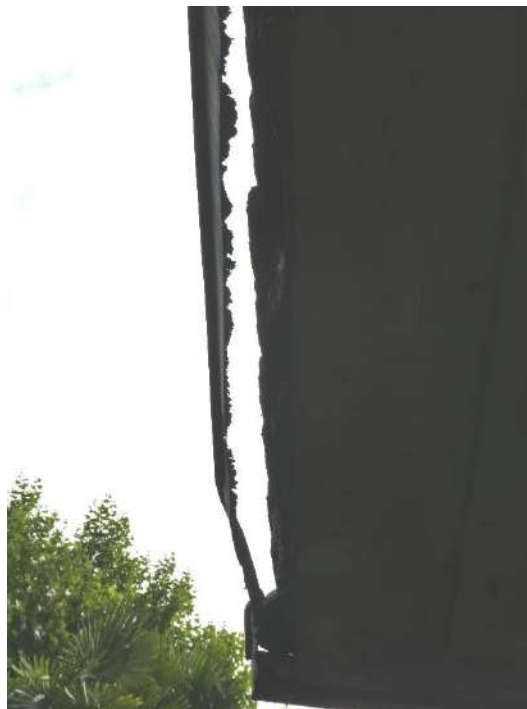
29. – Abitazione mappale 195 sub. 5: particolare grondaie del fabbricato
