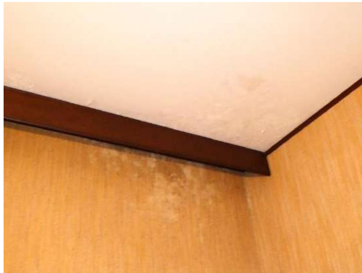
24. – Abitazione mappale 195 sub. 5: infiltrazioni presenti nei soffitti dei locali
