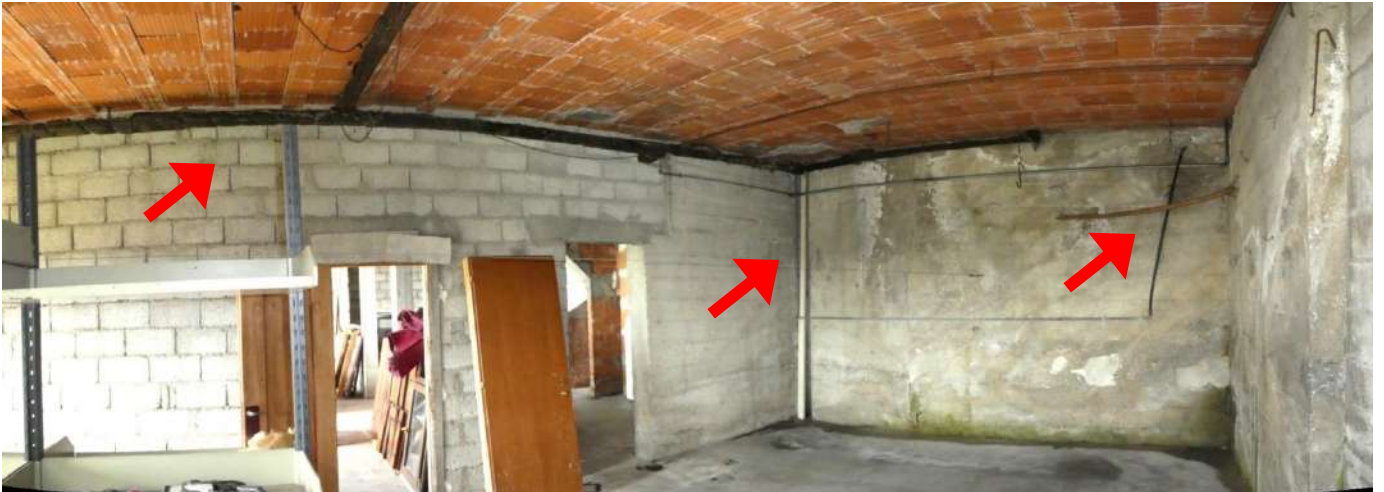
30. – Unità mappale 195 sub. 8-9 nel piano Interrato (non oggetto di pignoramento): presenza delle tubazioni degli impianti dell’Abitazione mappale 195 sub. 5
