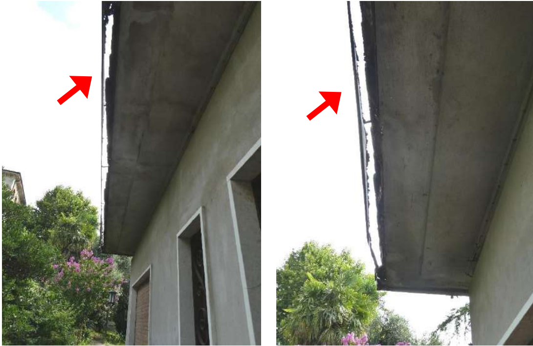
28. – Abitazione mappale 195 sub. 5: stato delle grondaie del fabbricato
