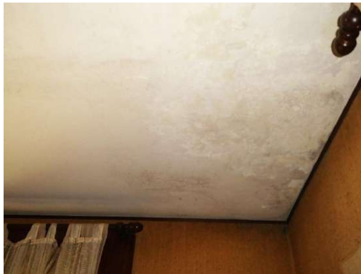
26. – Abitazione mappale 195 sub. 5: infiltrazioni presenti nei soffitti dei locali
