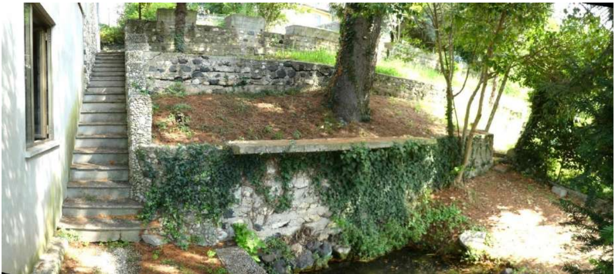
43. – Corte comune mappale 195 sub. 7: porzione lato Est con scale esterne di collegamento tra piano Terra ed Interrato
