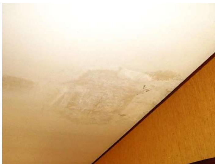
27. – Abitazione mappale 195 sub. 5: infiltrazioni presenti nei soffitti dei locali
