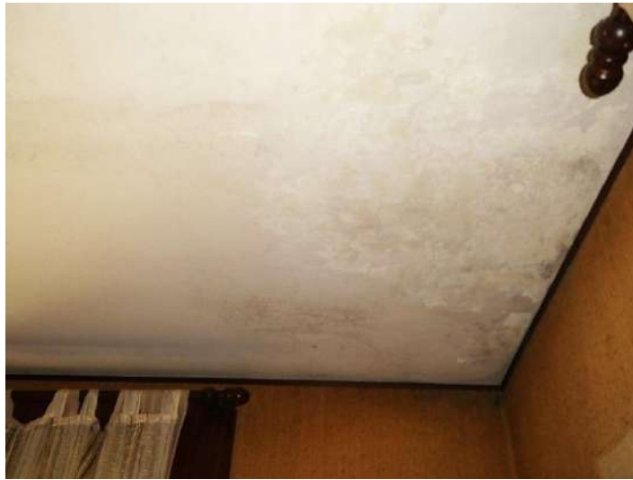
26. – Abitazione mappale 195 sub. 5: infiltrazioni presenti nei soffitti dei locali
