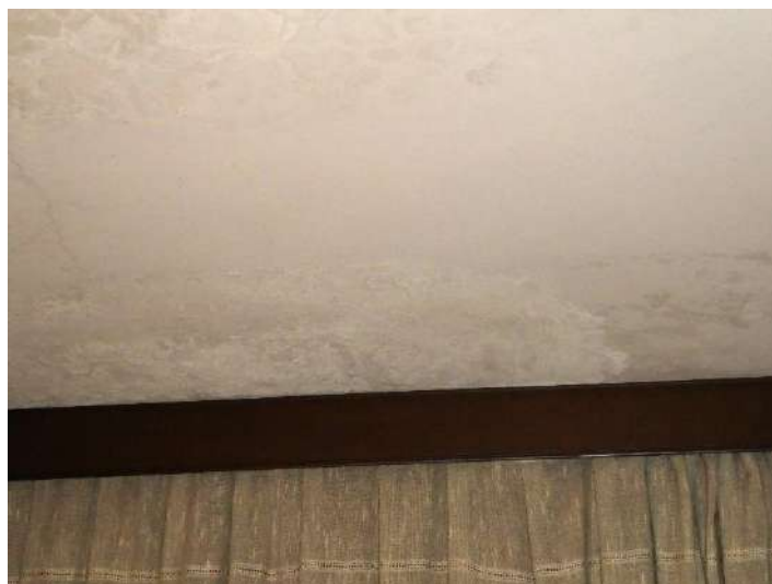
25. – Abitazione mappale 195 sub. 5: infiltrazioni presenti nei soffitti dei locali
