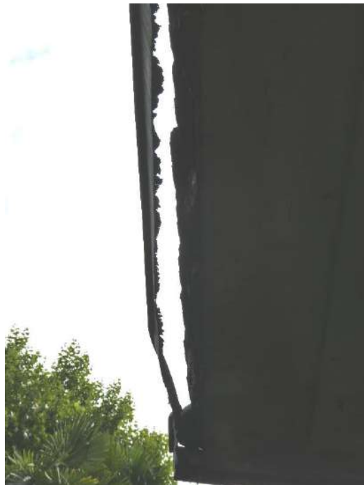
29. – Abitazione mappale 195 sub. 5: particolare grondaie del fabbricato
