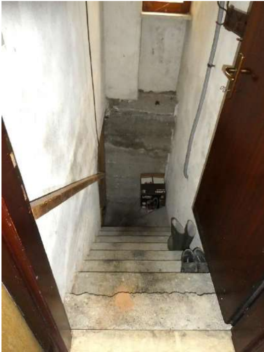
18. – Scala di collegamento tra piano Terra ed Interrato (non più utilizzabile)
