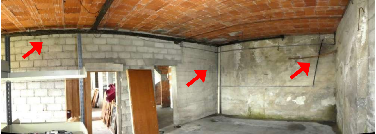
30. – Unità mappale 195 sub. 8-9 nel piano Interrato (non oggetto di pignoramento): presenza delle tubazioni degli impianti dell’Abitazione mappale 195 sub. 5
