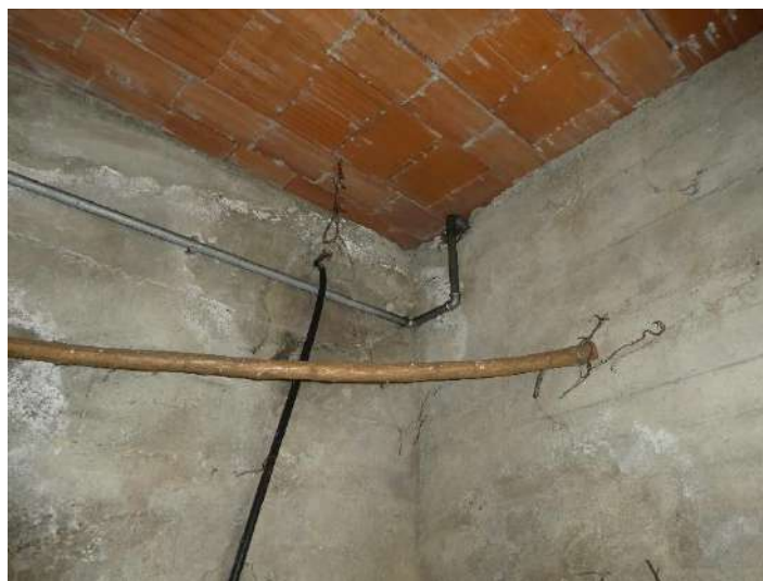
33. – Unità mappale 195 sub. 8-9 nel piano Interrato (non oggetto di pignoramento): presenza delle tubazioni degli impianti dell’Abitazione mappale 195 sub. 5
