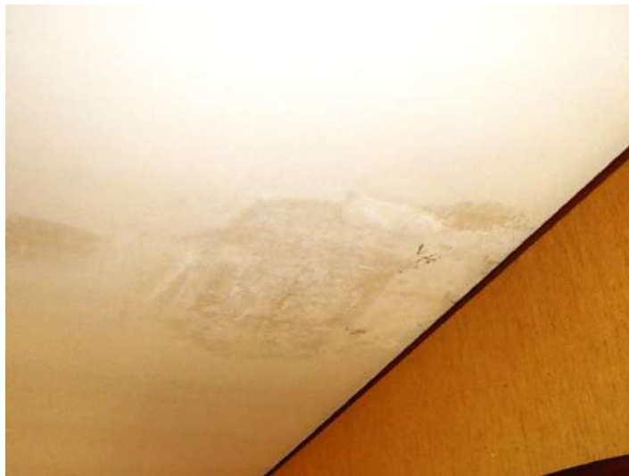
27. – Abitazione mappale 195 sub. 5: infiltrazioni presenti nei soffitti dei locali
