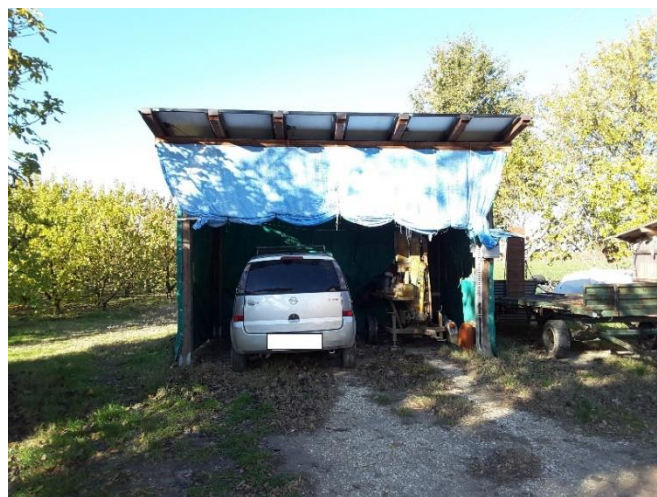
Vista della tettoia di sostegno dei pannelli fotovoltaici (sub.5)
