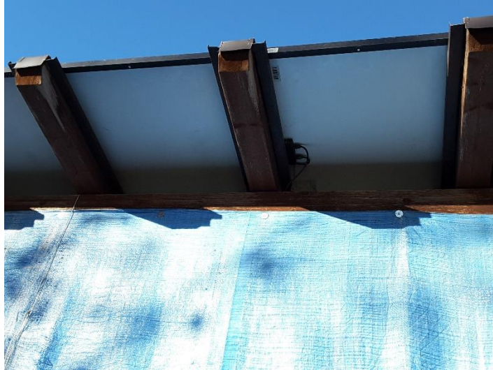
Vista dei pannelli fotovoltaici
