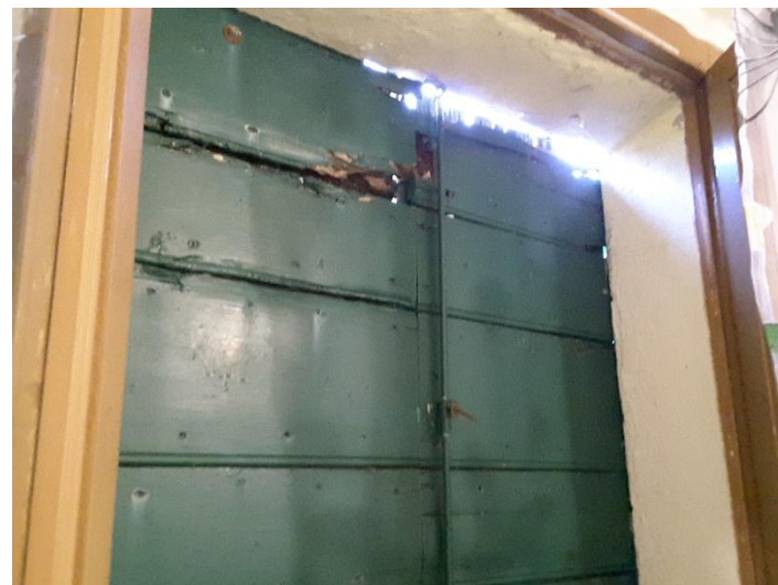
Vista interna del fabbricato sub. 2 (stato manutentivo)
