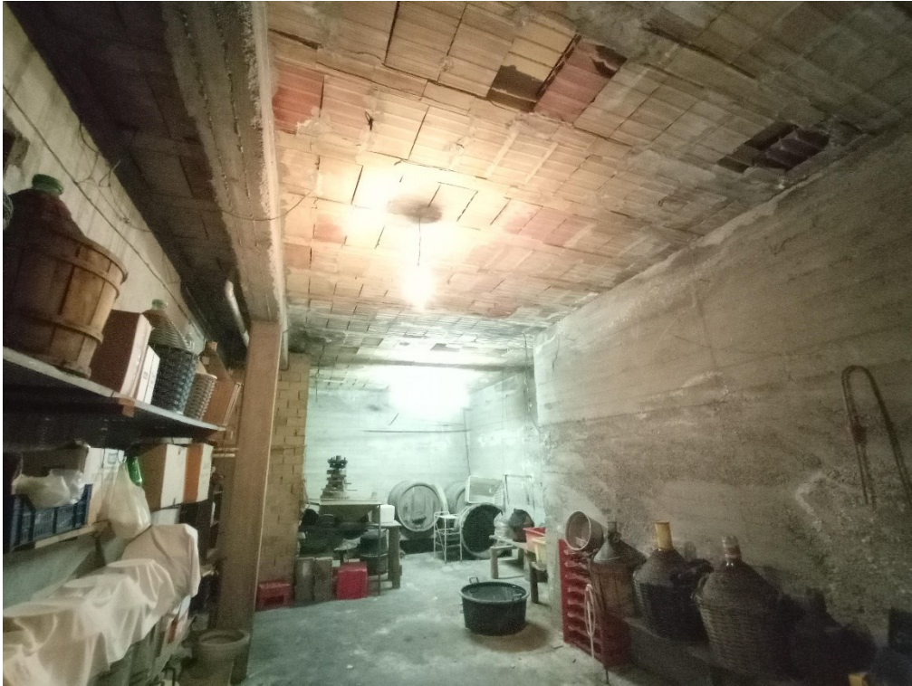
Vista soffitto terrazzo con infiltrazioni
