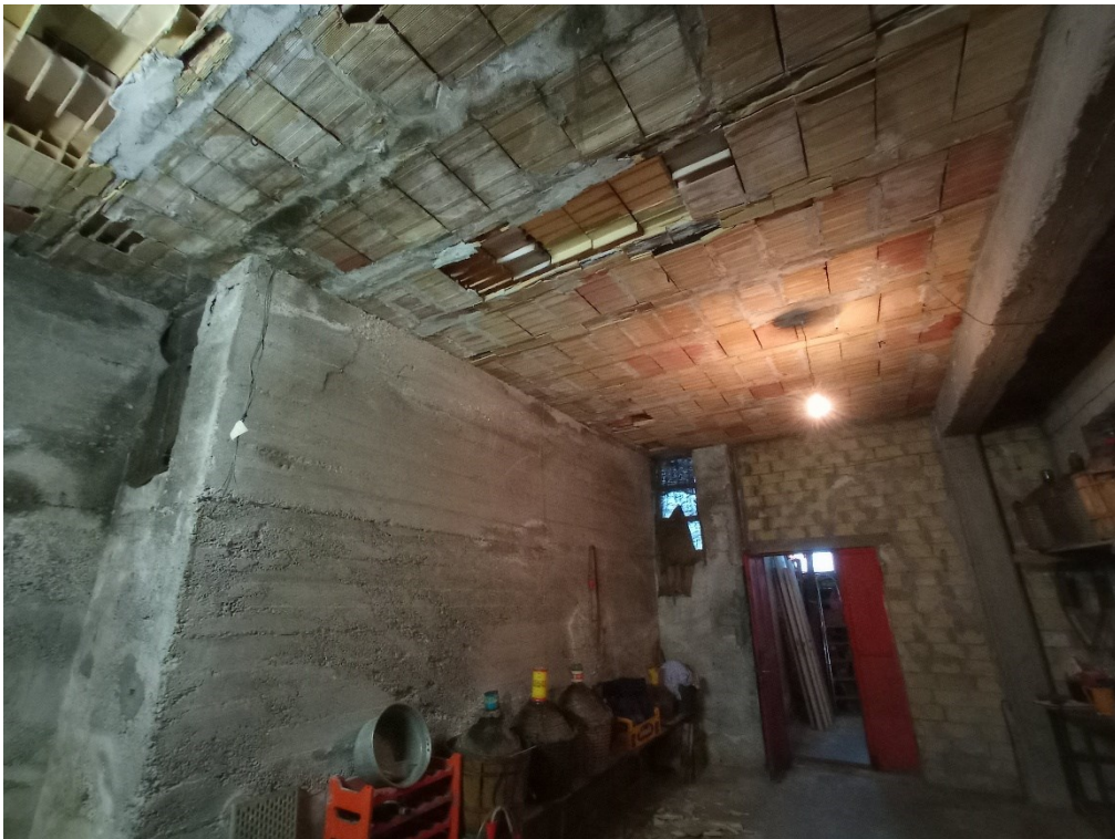
Vista soffitto terrazzo con infiltrazioni
