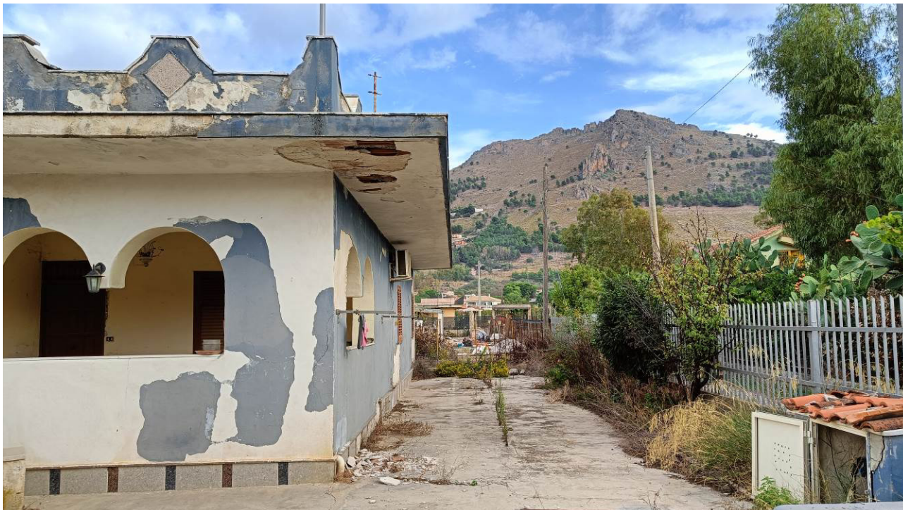
FOTO 38 – Lesione sul pilastro e sfondellamento soletta pensilina
