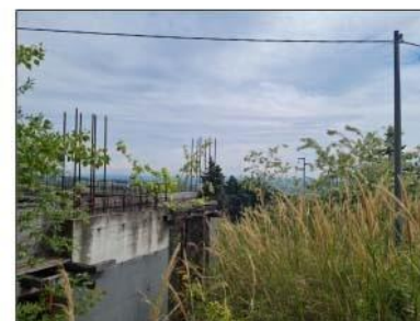
FOTO 21 - Piano seminterrato senza solaio superiore
