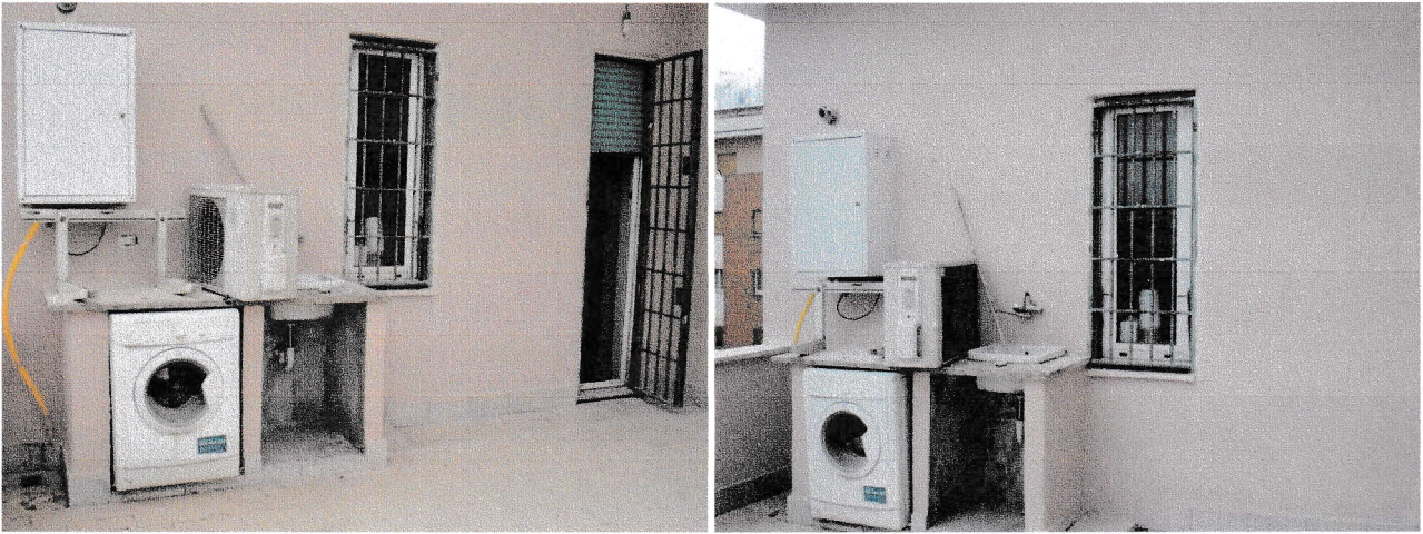
Foto n° 23 e 24: Particolari degli accessori presenti sul terrazzo. Si notano, una lavatrice, una caldaia e una vecchia unità esterna per condizionatore e un piccolo lavabo. Porta e finestra sono dotate di grate di protezione in ferro.
