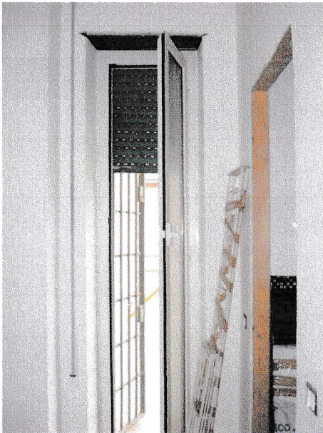
Foto n° 19: La porta di accesso al terrazzo di pertinenza vista dall'interno e l'accesso al 2° bagno dove manca la bussola.
