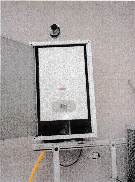
Foto n° 25: Particolare vista della caldaia.
