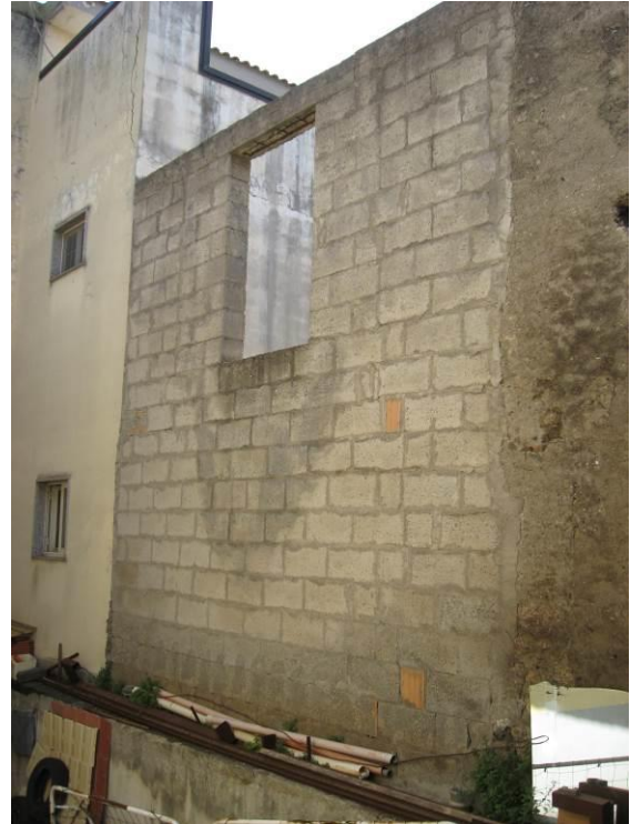
Figura 7 facciata nord/ovest del fabbricato crollato
