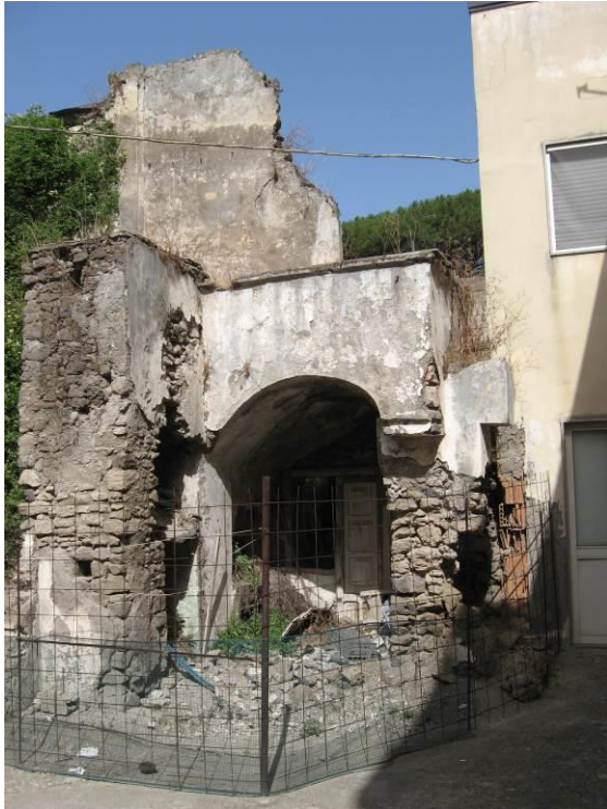
Figura 6 facciata sud/est del fabbricato crollato
