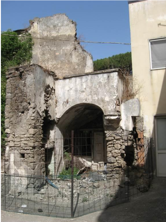
Figura 6 facciata sud/est del fabbricato crollato
