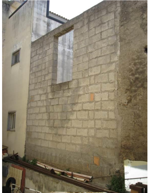
Figura 7 facciata nord/ovest del fabbricato crollato
