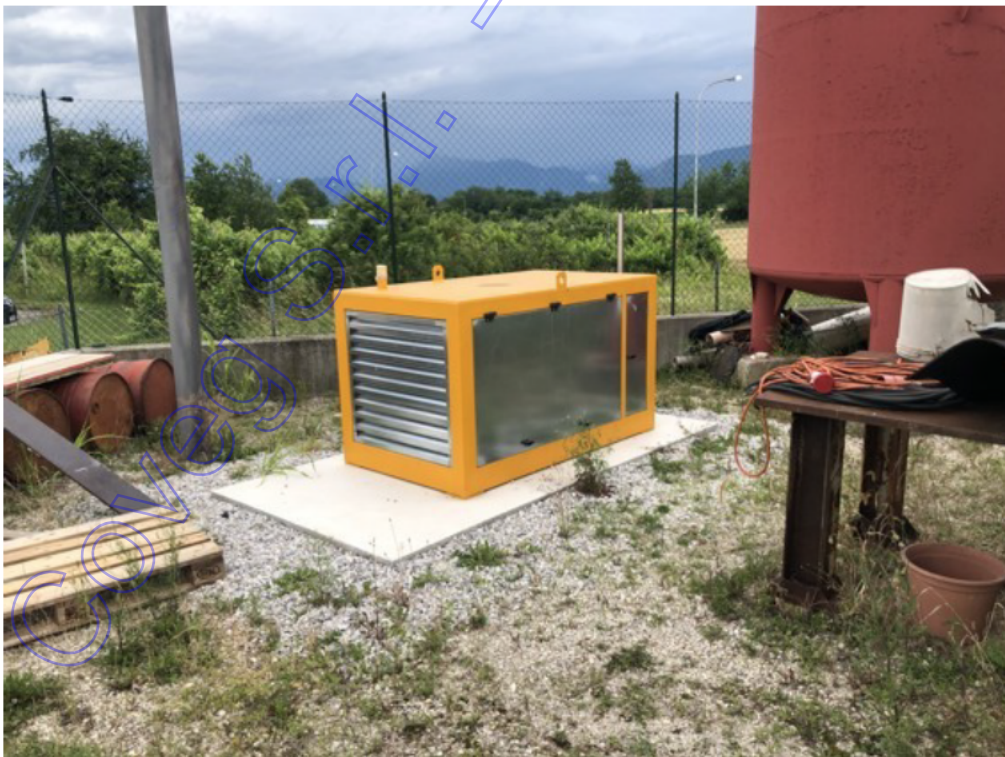
Fotografia A.6 - Particolare generatore corrente a combustibile verso confine ovest Pagina 3 di 6
