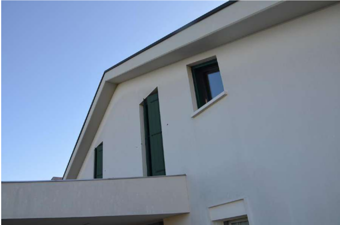
Prospetto est con portico abusivo
