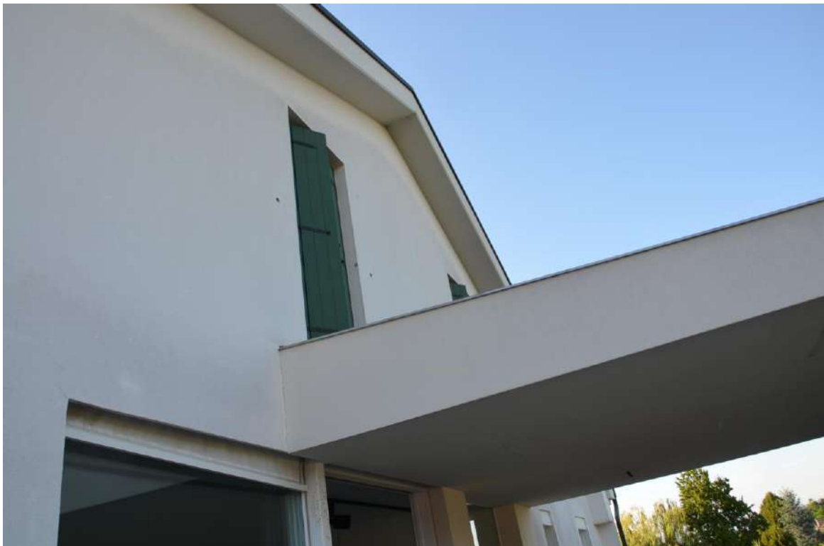
Prospetto est con portico abusivo
