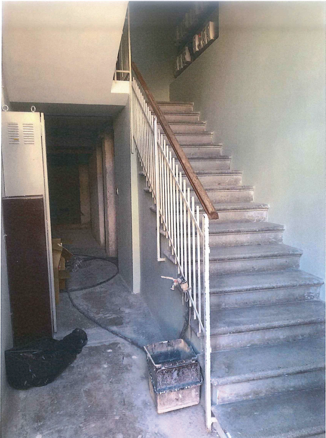
Foto n. 6 – Come foto n.5, proseguendo all'interno. Vista zona contatori elettrici.
