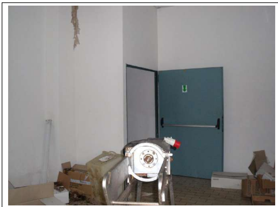
21. Interno “deposito cartoni” dell’unità immobiliare al piano terra, con vista lato sud, in foto insufficiente stato di manutenzione.
