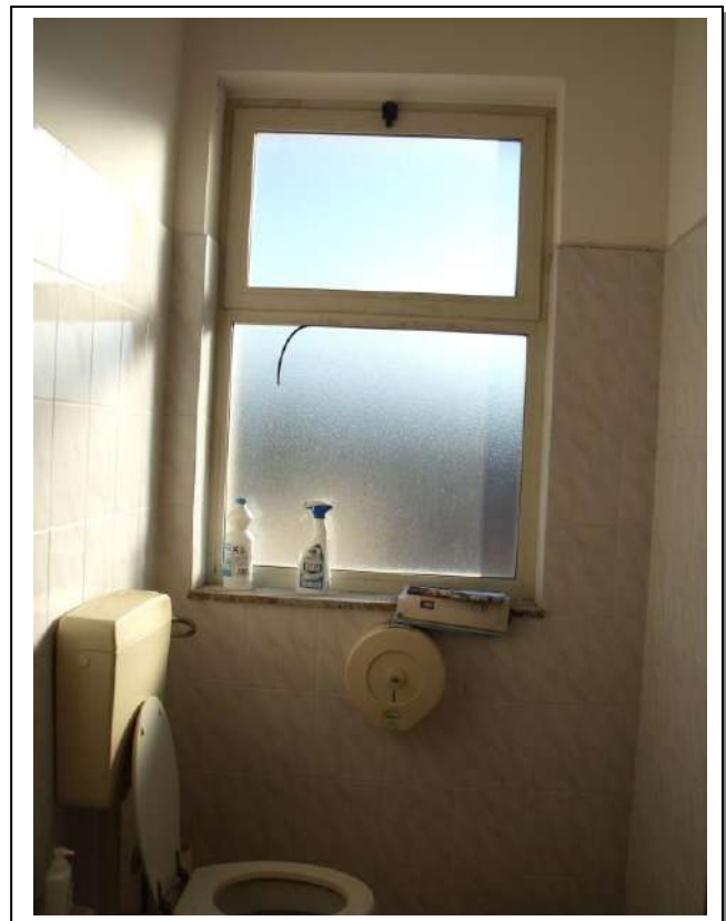
66. Interno “servizio igienico dell’uff. direzione” dell’u. i. al piano primo, con vista lato sud-ovest, in foto discreto stato di manutenzione.
