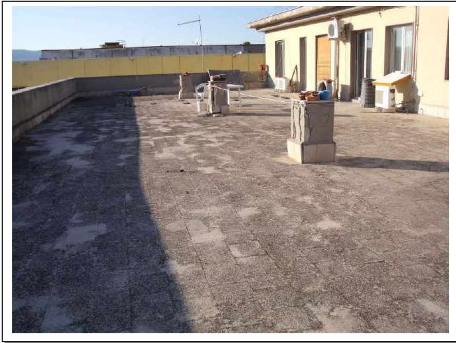
87. Esterno “terrazza praticabile” dell’unità immobiliare al piano primo, con vista lato nord-ovest, in foto cattivo stato di manutenzione.
