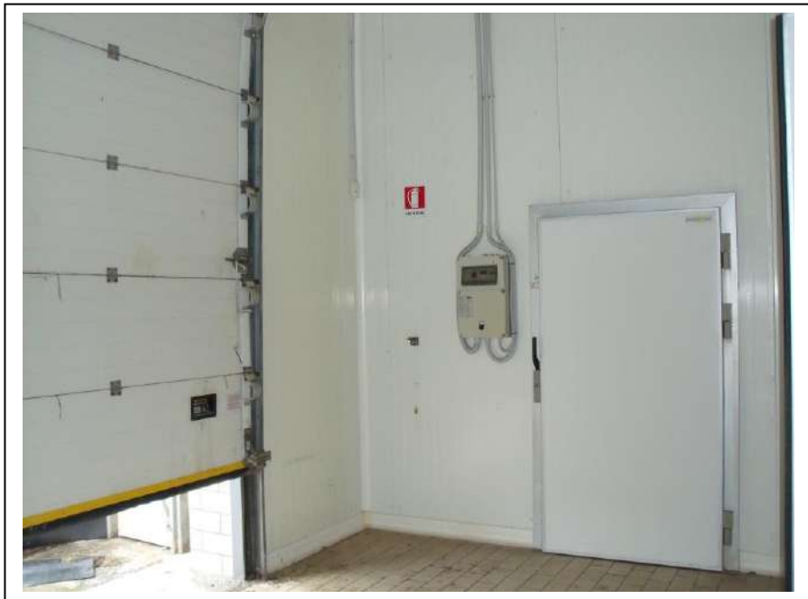
29. Interno "ingresso merci" dell'unità immobiliare al piano terra con vista lato ovest, in foto sufficiente stato di manutenzione.
