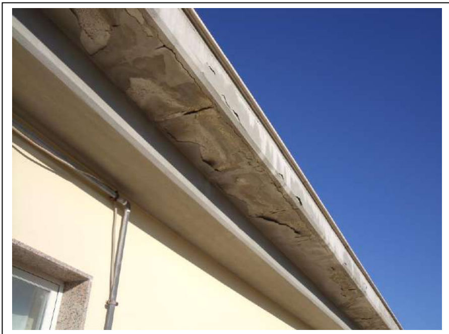
88. Esterno “terrazza praticabile” dell’unità immobiliare al piano primo, con vista lato nord-est, particolare linea di gronda del tetto, in foto cattivo stato di manutenzione.
