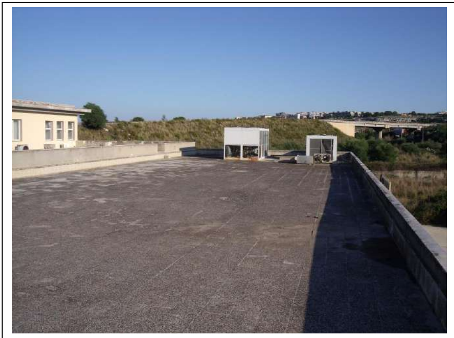
86. Esterno “terrazza praticabile” dell’unità immobiliare al piano primo, con vista lato sud-est, in foto cattivo stato di manutenzione.
