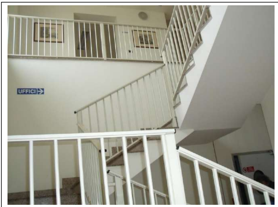
10. Interno dell'unità immobiliare (industria) al piano terra con vista lato sud-ovest, in foto corpo scala di collegamento con il piano superiore (uffici amministrativi dell'industria). Buono lo stato di manutenzione.
