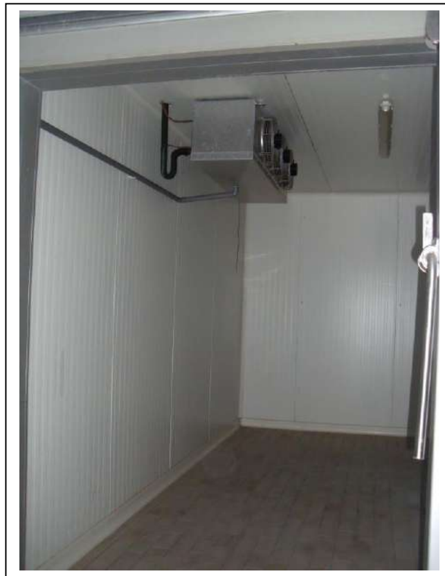
34. Interno “cella frigorifera” dell’unità immobiliare al piano terra, con vista lato nord-est, in foto sufficiente stato di manutenzione.
