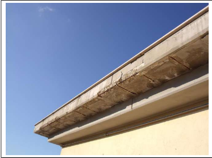
89. Esterno “terrazza praticabile” dell’unità immobiliare al piano primo, con vista lato nord, particolare linea di gronda del tetto, in foto cattivo stato di manutenzione.
