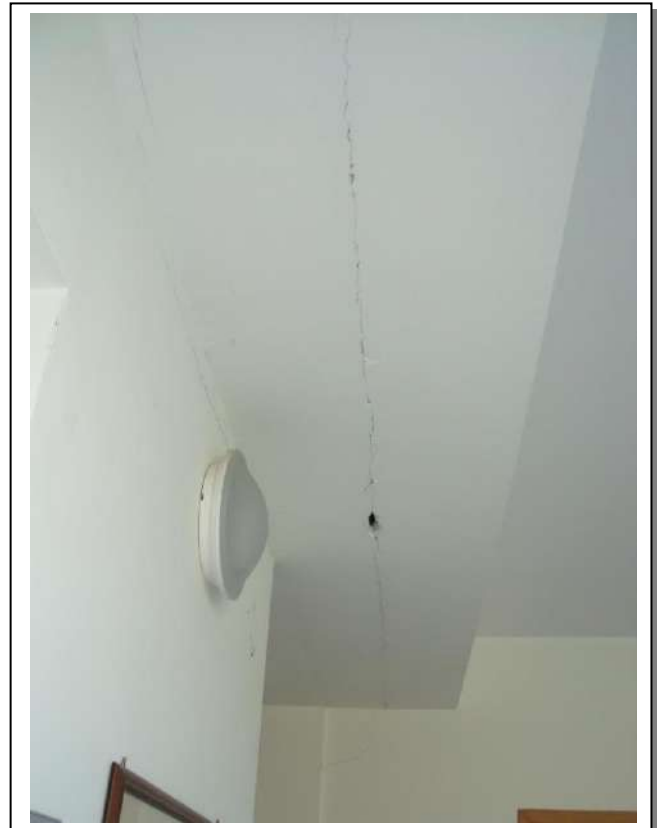
73. Interno "zona disimpegno" dell'unità immobiliare al piano primo, con vista lato nord-ovest verso soffitto, in foto lesione orizzontale intonaco in prossimità di travi con giunto strutturale.
