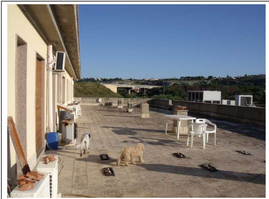
84. Esterno “terrazza praticabile” dell’unità immobiliare al piano primo, con vista lato sud-est, in foto cattivo stato di manutenzione.
