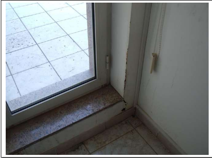
71. Interno "reception" dell'unità immobiliare al piano primo, con vista lato est, in foto cattivo stato di manutenzione.
