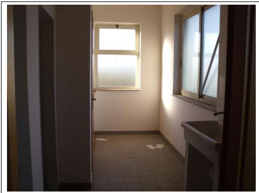
48. Interno “antibagno spogliatoio donne” dell’unità immobiliare al piano primo, con vista lato nord, in foto buono stato di manutenzione.
