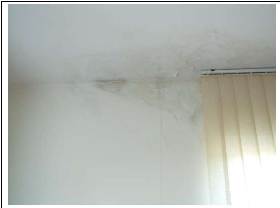
64. Interno “ufficio direzione” dell’unità immobiliare al piano primo, con vista lato sud-est, in foto cattivo stato di manutenzione.
