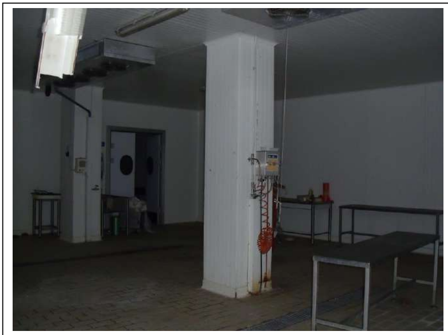
16. Interno vano “laboratorio sezionamento busti” dell’unità immobiliare al piano terra, con vista lato sud-ovest, in foto discreto stato di manutenzione.
