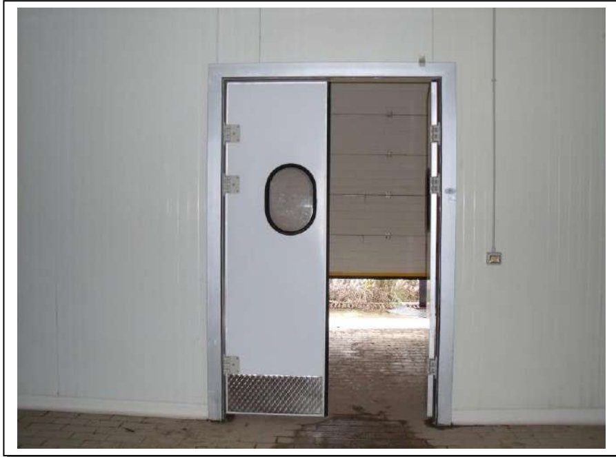
28. Interno dell'unità immobiliare al piano terra, con vista lato sud-ovest, in foto scarso stato di manutenzione.
