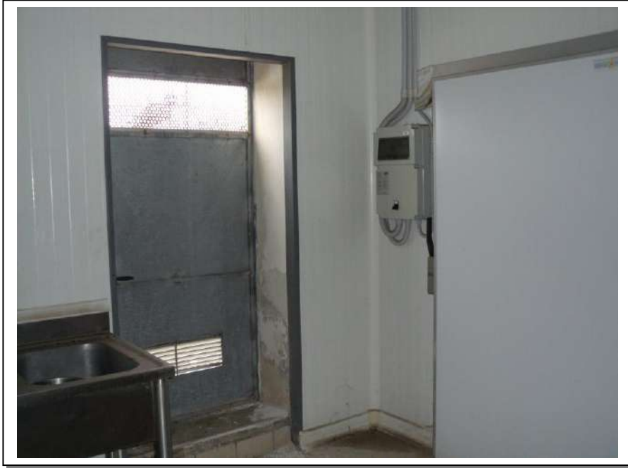
22. Interno “laboratorio” dell’unità immobiliare al piano terra, con vista lato ovest, in foto insufficiente stato di manutenzione.
