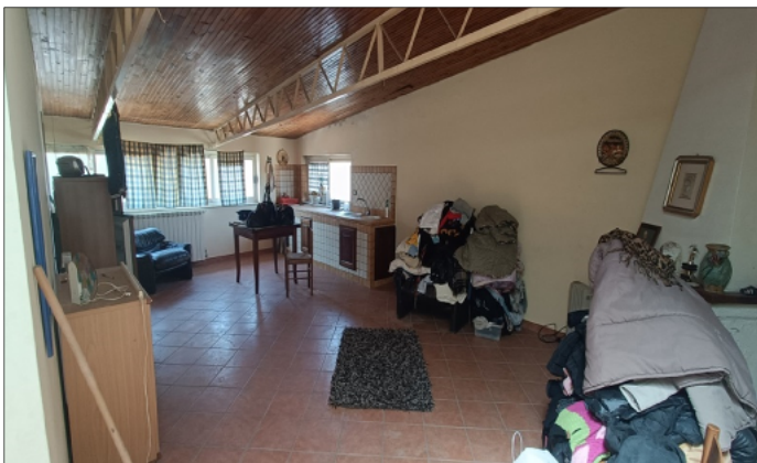
Vano aggiuntivo P3° (abusivo)
