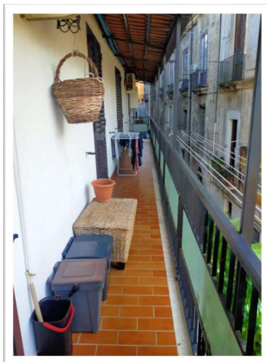
Figura n. 18 - Foto Balcone da Sanare/Demolire
