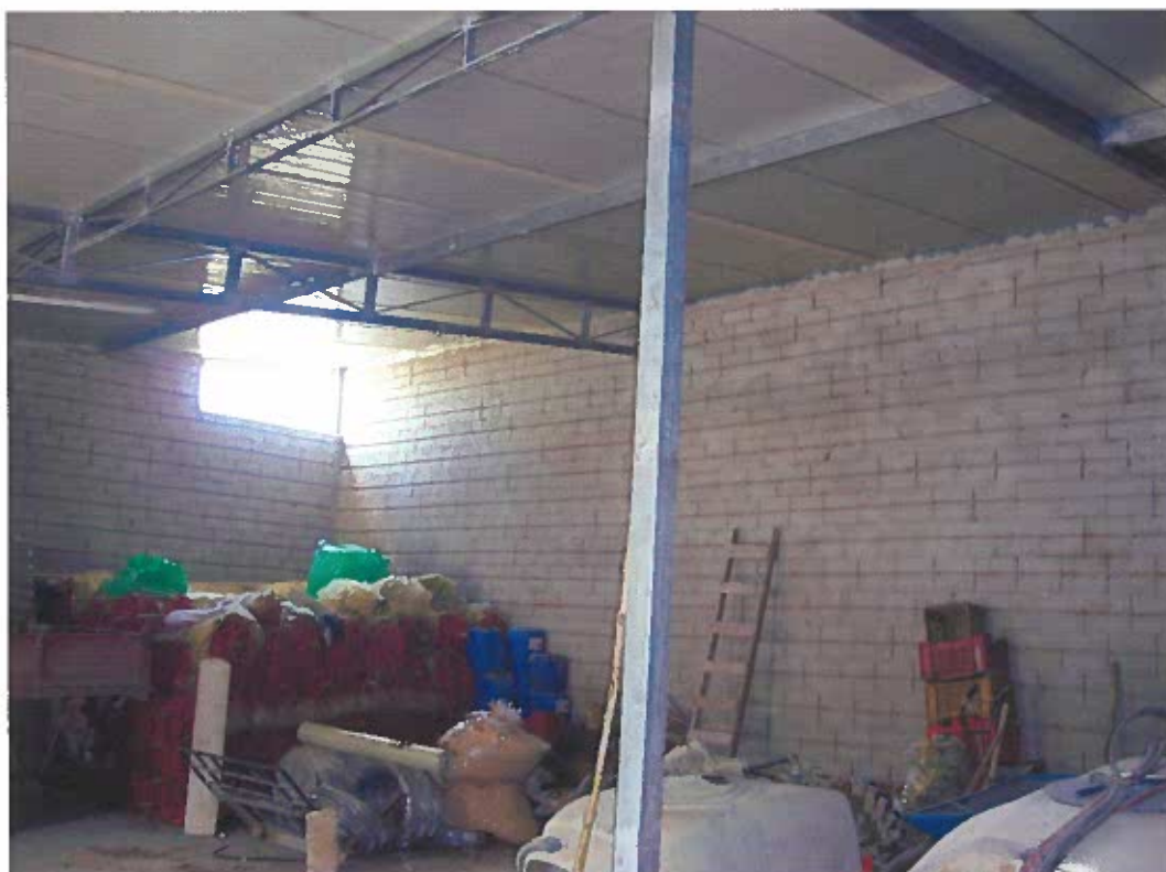
Foto 30 . Vista interna del Locale Ricovero Attrezzi e Macchinari ( si nota struttura precaria ).
