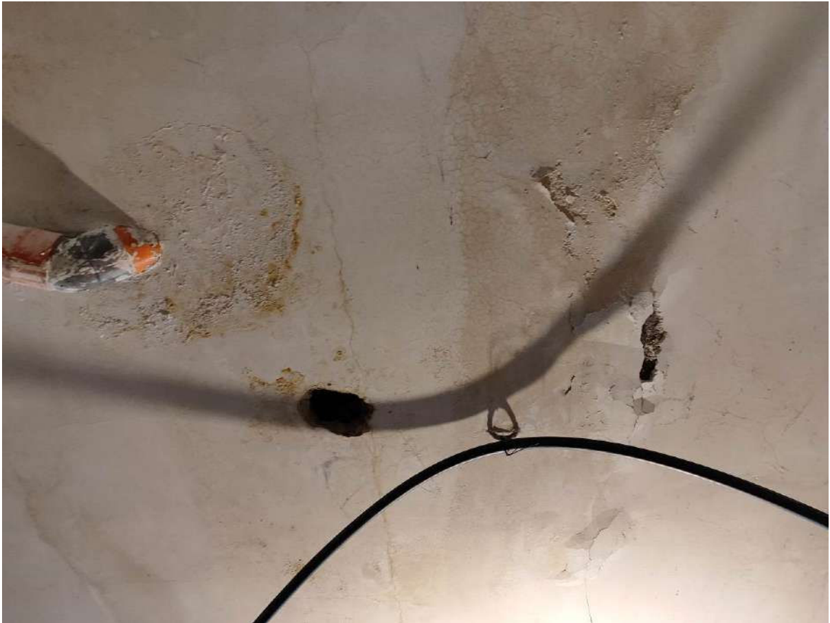
Foto 33 - Interni piano terra, infiltrazione garage
