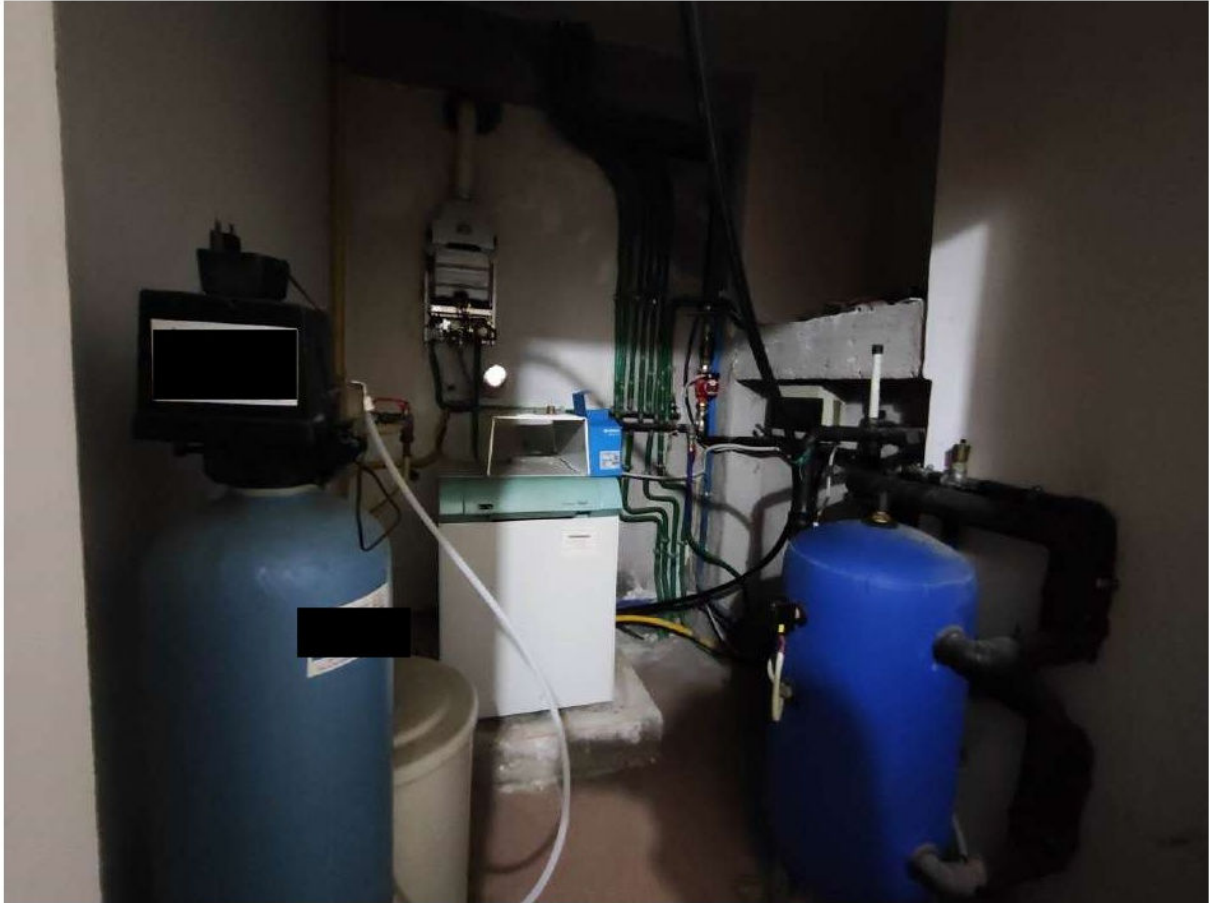
Foto 39 - Interni piano terra, vano tecnico
