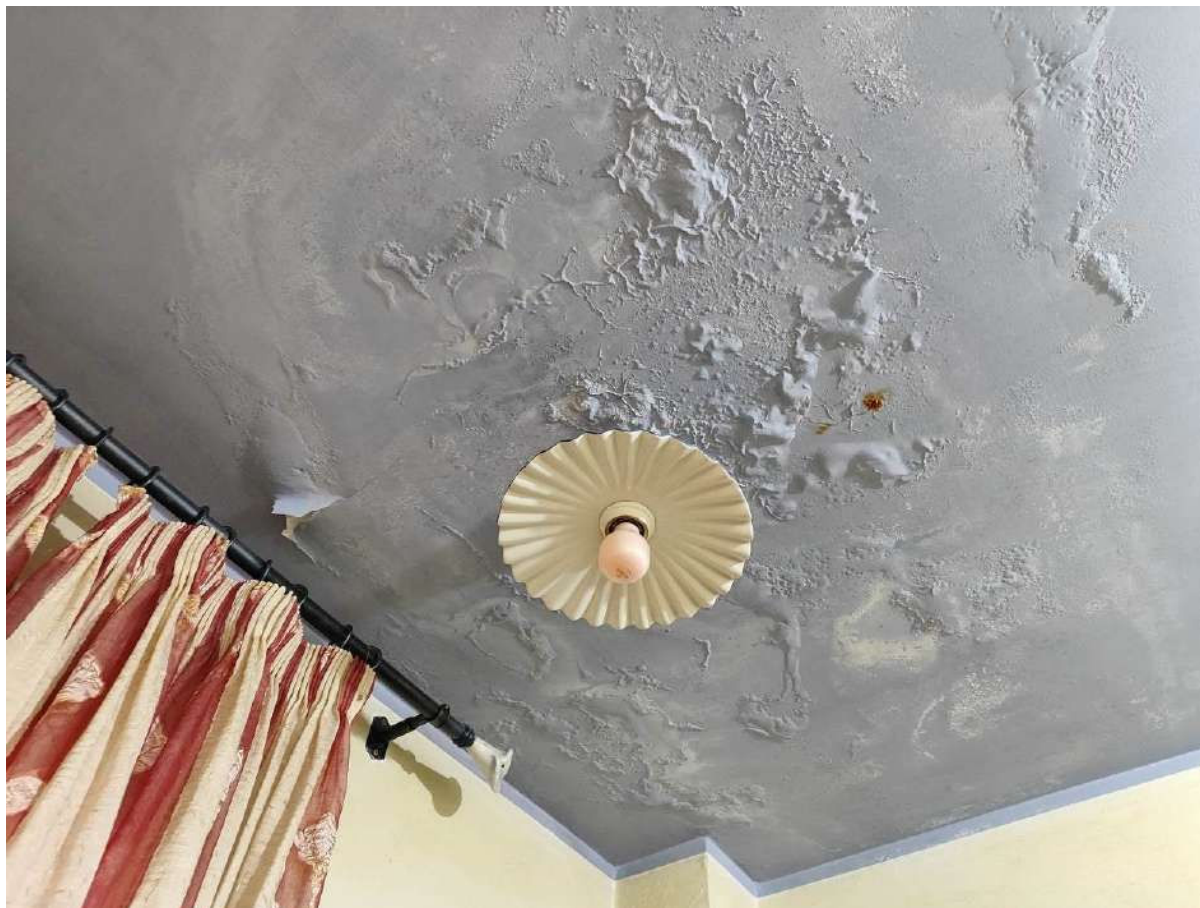
Foto 31 - Interni piano terra, infiltrazione wc
