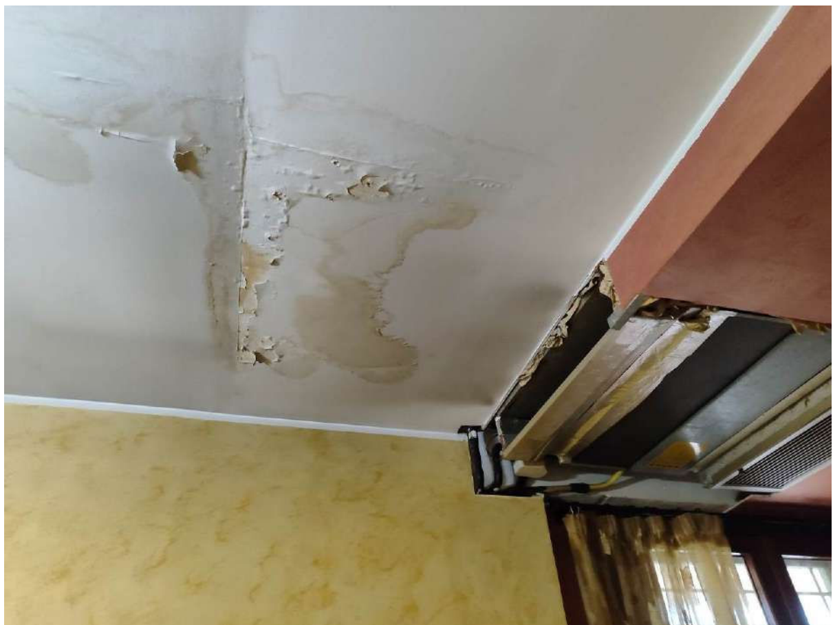
Foto 22 - Interni piano terra, infiltrazione in cucina
