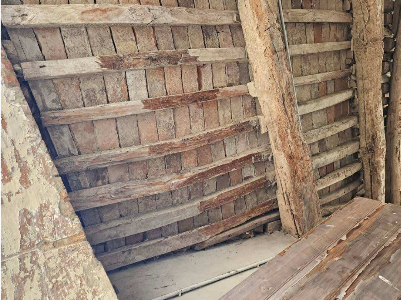
PARTICOLARE DEL SOLAIO DELL'ANDRONE CARRAIO IN PRECARIE CONDIZIONI STATICHE COSTITUENTE IL PAVIMENTO DEL LOCALE AL PIANO PRIMO
