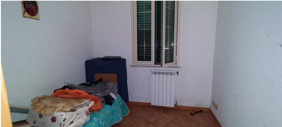
Foto n. 12 - Vani interni dell'unità immobiliare, infissi in alluminio e vetro, i vani sono dotati di piastre riscaldanti - fenomeni di umidità di risalita
