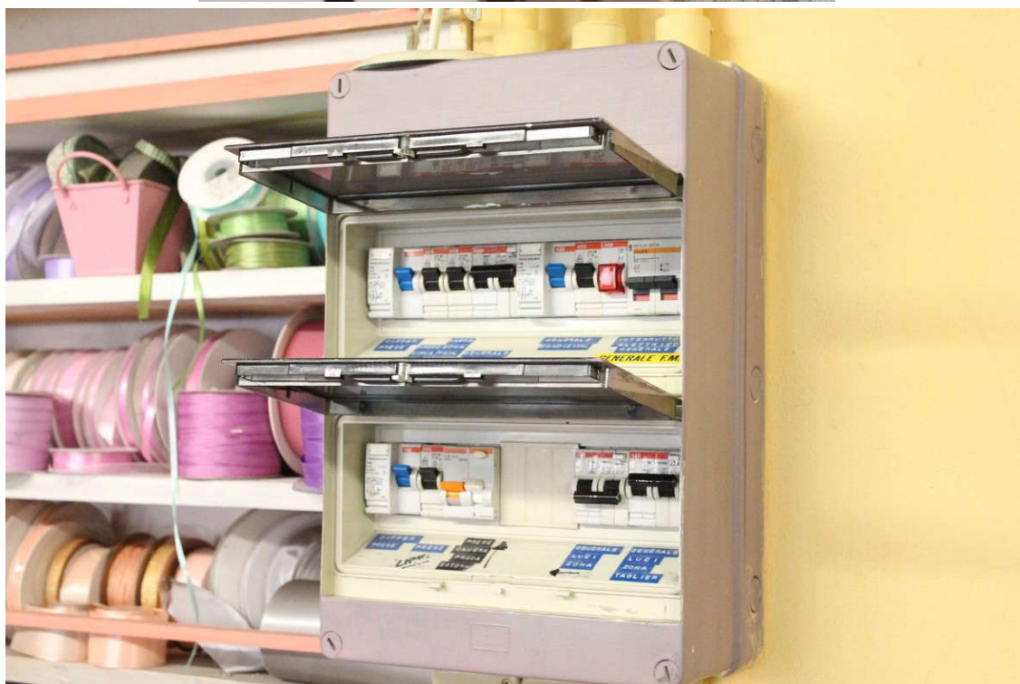
Particolare quadro elettrico posto nel magazzino
