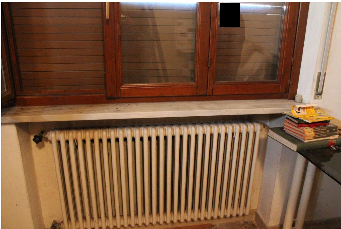
Radiatore in acciaio locale piano terra
