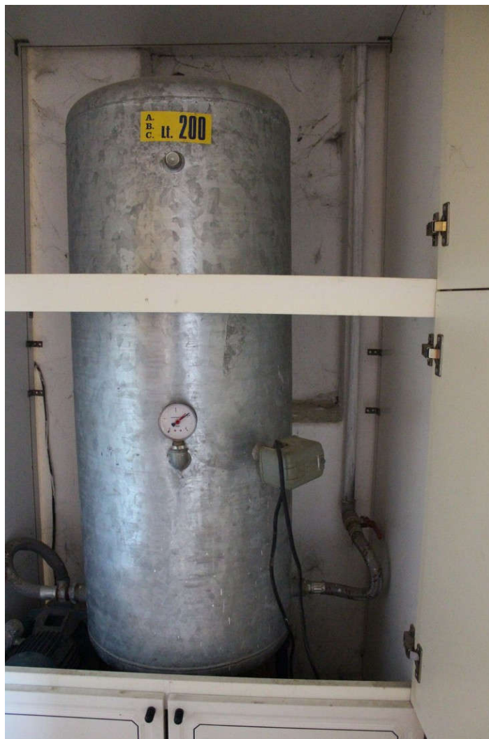
Serbatoio accumulo acqua calda
