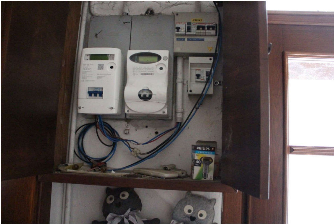
Contatori energia elettrica posti nel locale ex cucina al piano terra
