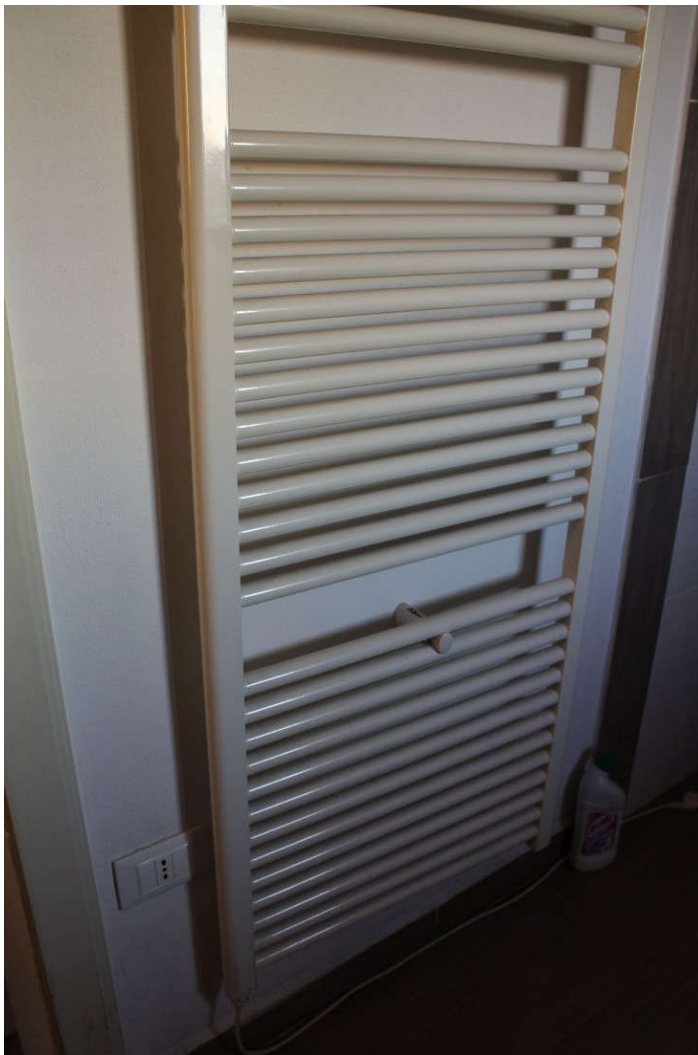
Scaldasalviette elettrico nel bagno lavanderia del primo piano
