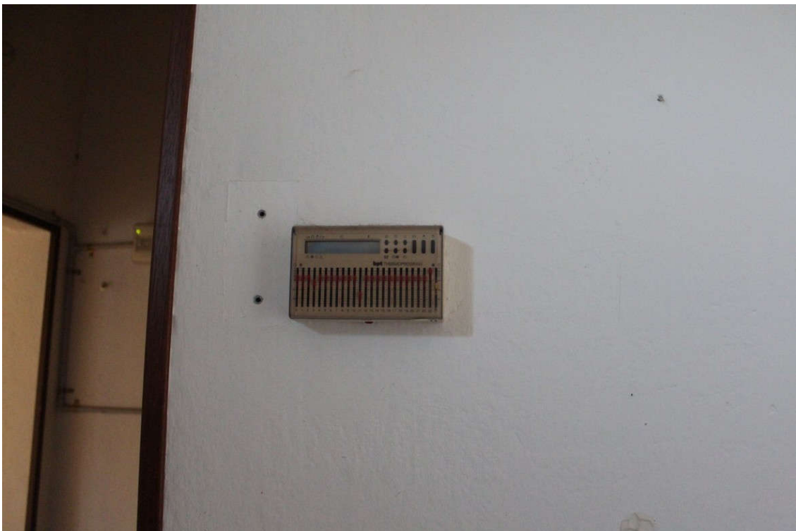
Cronotermostato posto nello stesso locale ex cucina, attualmente non collegato ad alcun generatore
