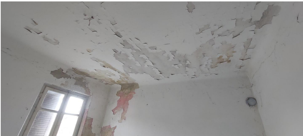
FOTO 21 – soffitto camera al piano primo
