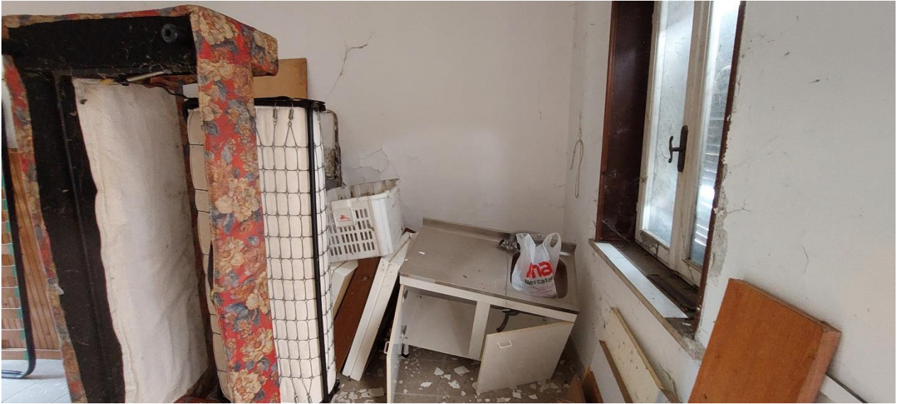
FOTO 13 – Cucina al piano terreno
