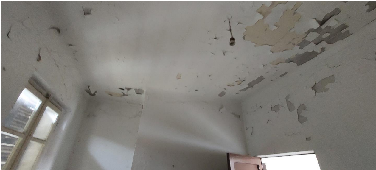
FOTO 19 – soffitto camera al piano primo
