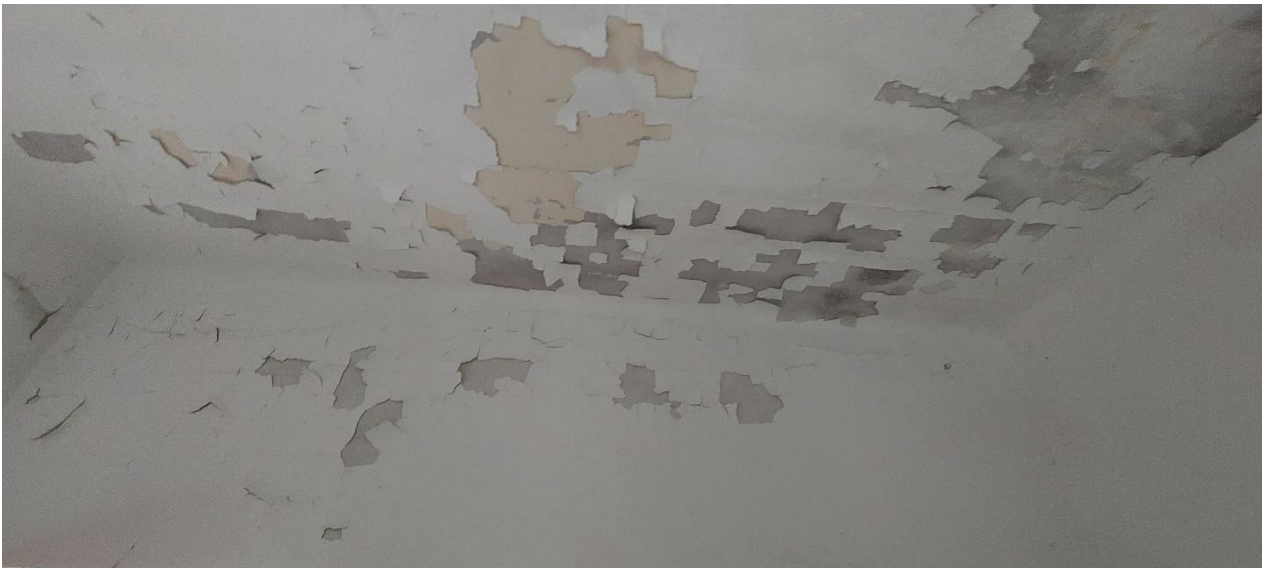
FOTO 20 – soffitto camera al piano primo
