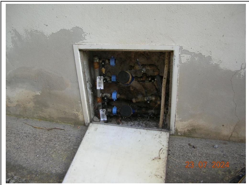
Contatori Acque ubicati in Via Torre
