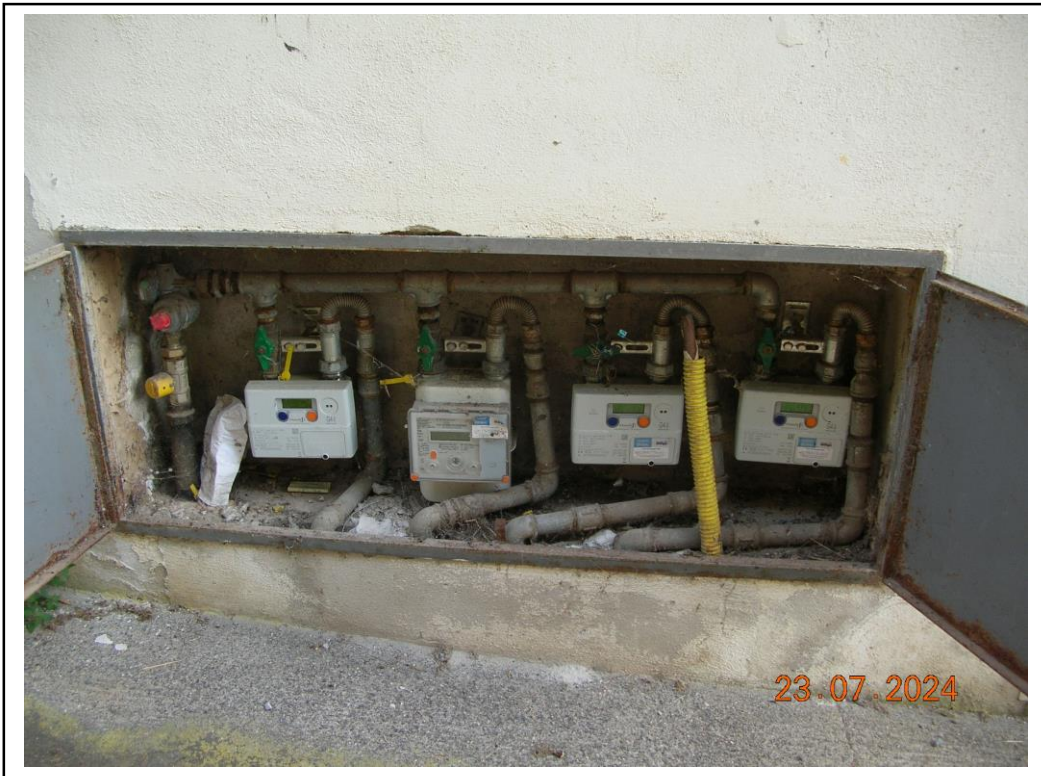
Contatori metano ubicati in Via Torre
