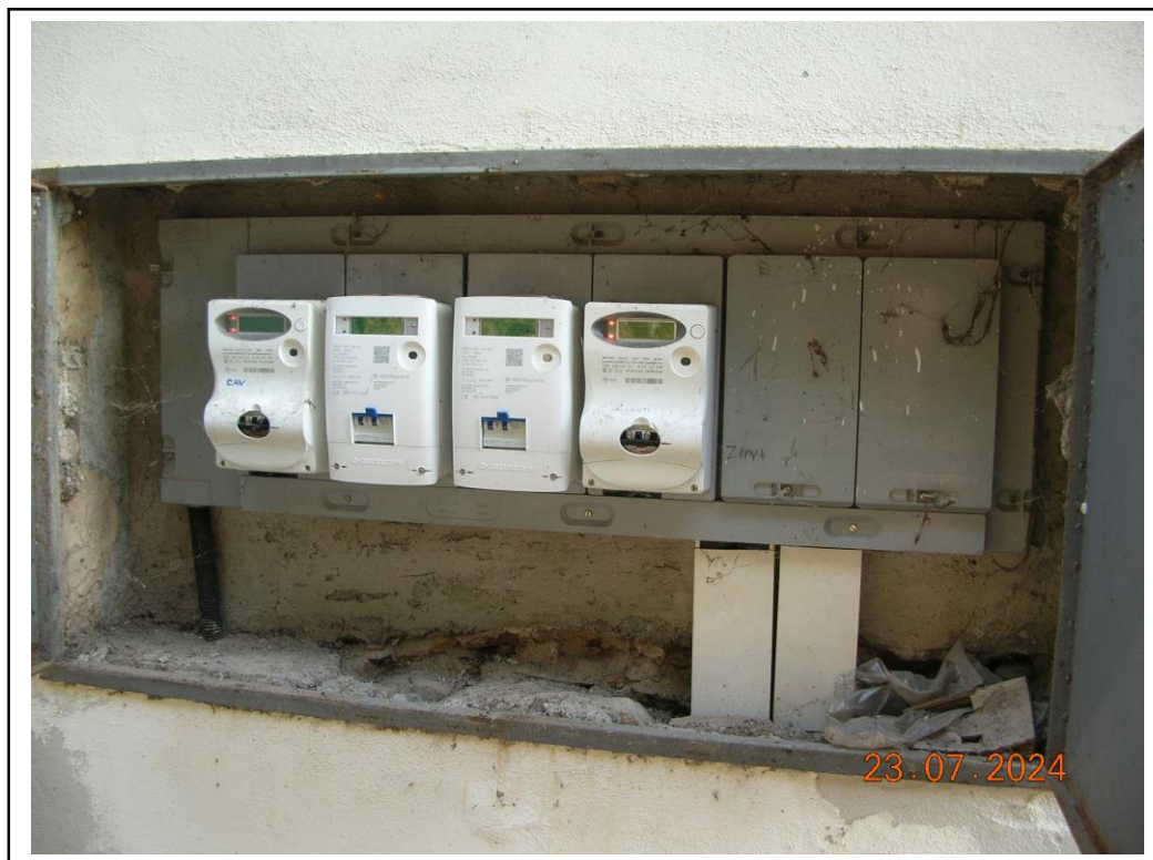
Contatori Enel ubicati in Via Torre
