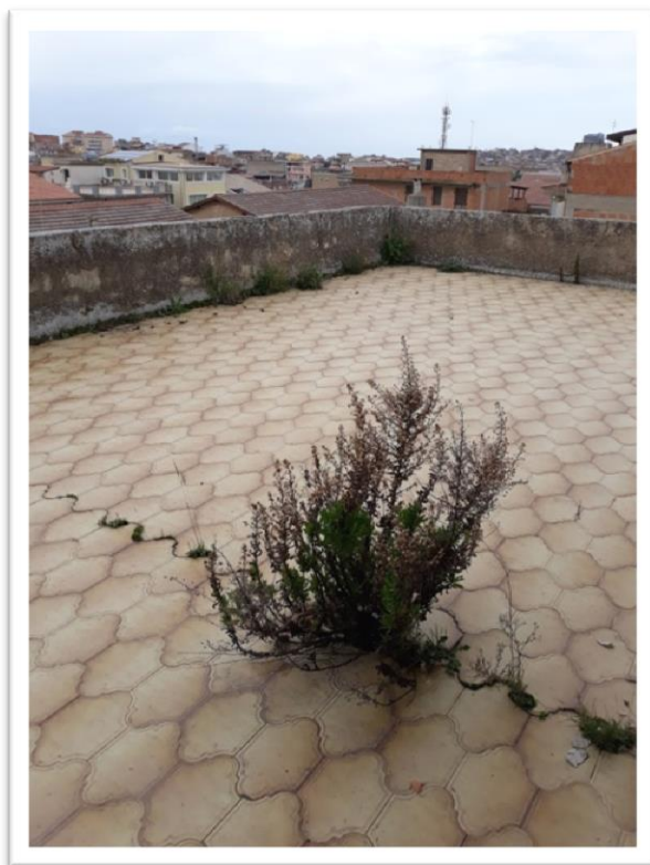
Foto 4: Particolare terrazza con vegetazione spontanea. Punti in cui si insinua l'acqua.
