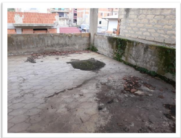
Foto 1: Avvallamenti e pavimentazione divelta.
