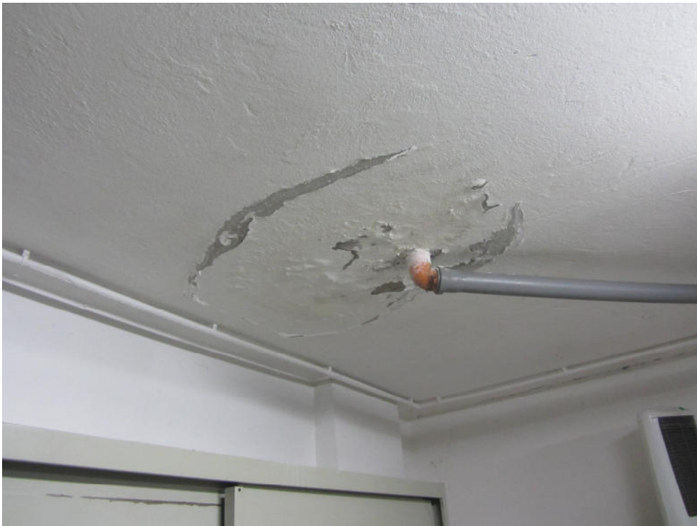
Foto n. 10 – vista infiltrazione d'acqua, al piano interrato
