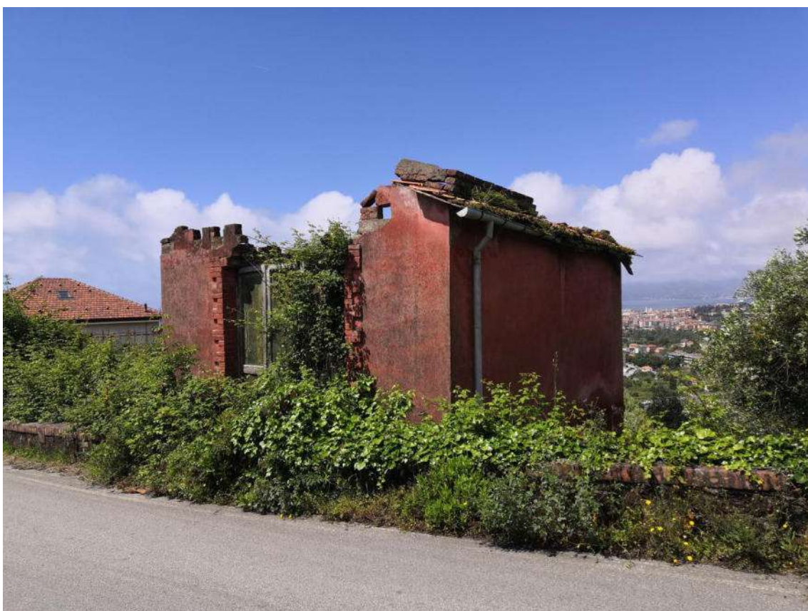
Foto 1 FABBRICATO PART. 1647 – DIRUTO -
