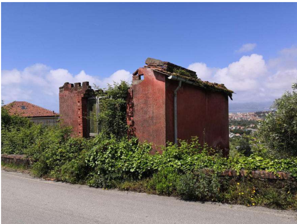
Foto 2 FABBRICATO PART. 1647 – DIRUTO -
