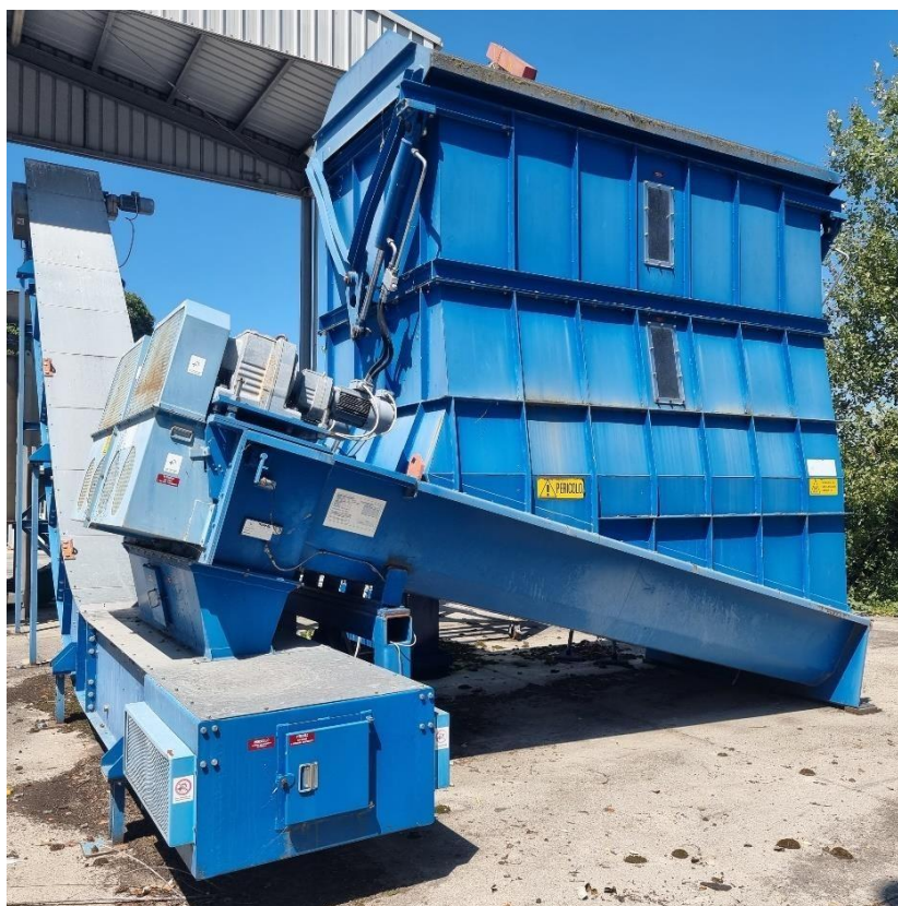
Fig.1 - Sistema di carico e trasporto biomassa
