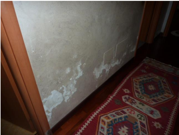
Umidità presente su parete divisoria disimpegno/bagno
