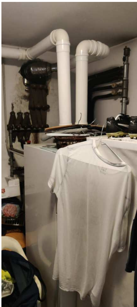
Foto n° 23 – Vista del locale caldaia al piano terra
