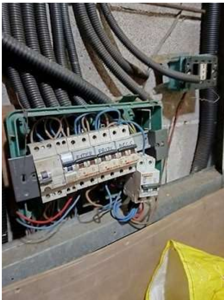
Quadro elettrico struttura 2
