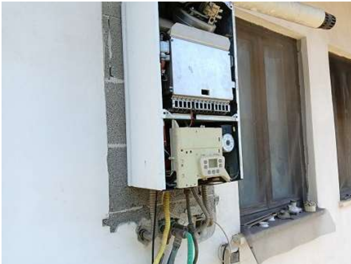
Caldaia non funzionante su esterno struttura 2
