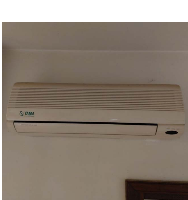
Foto 14: Condizionatore nel corridoio
