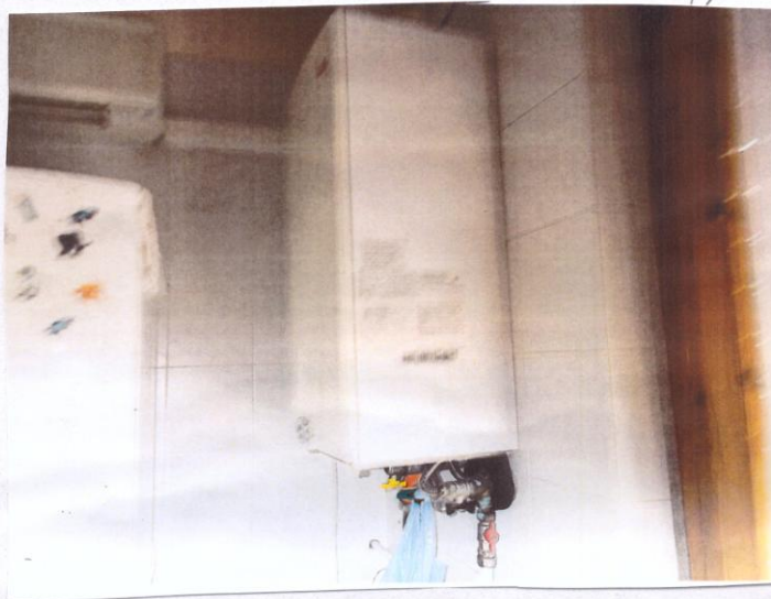
Foto n. 8 – Particolare della caldaia alimentata a gas
