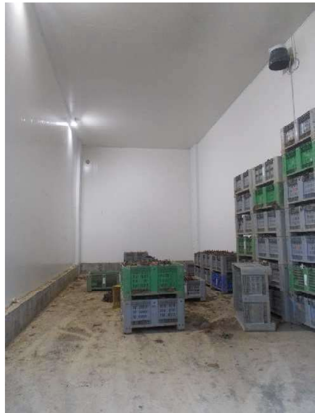
Lotto 2-Vista interna cella frigo
