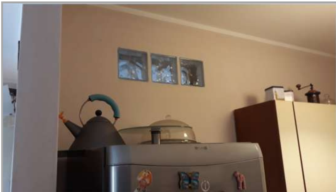
Foto " 12 " – Vista delle formelle in vetrocemento messe in opera in sostituzione della porta finestra presente nel titolo abilitativo che risulta essere stata tamponata
