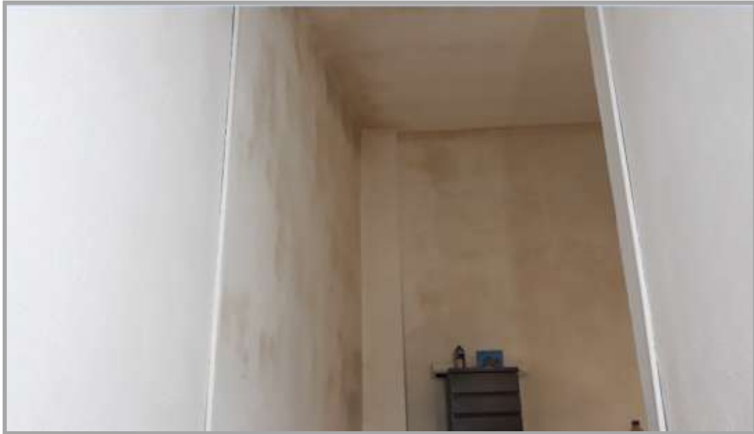
Foto " 21 " – Vista delle consistenti forme di condense e muffe che interessano l'appartamento e più marcatamente il vano sottotetto
