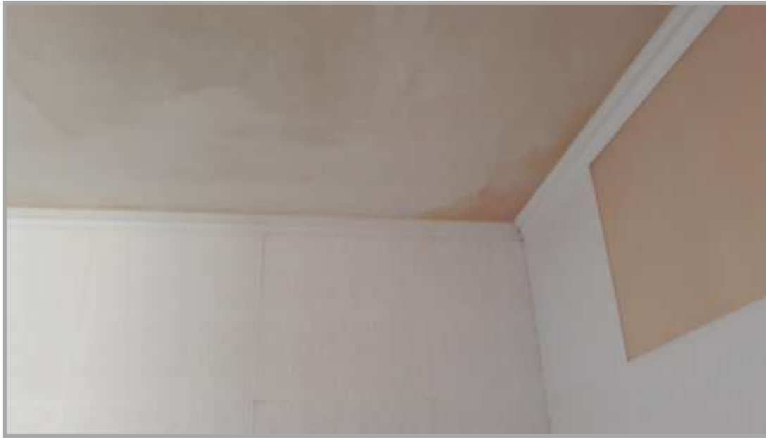
Foto " 19 " – Vista degli elementi in polistirolo posati nella muratura della camera al fine di ridurre le consistenti forme di condense e muffe causate dai probabili ponti termici
